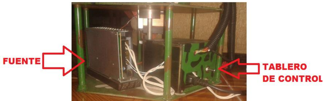
Figura 90 Fuente y tablero de control
