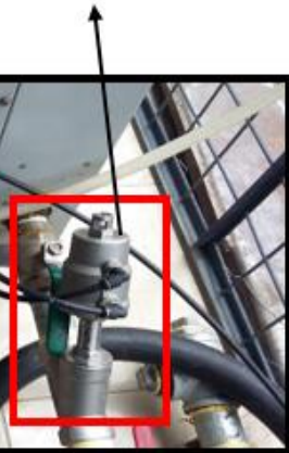
Válvula neumática a la salida del chiller.
