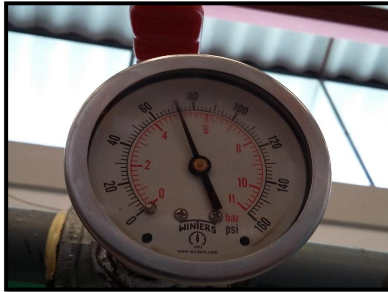
Figura 80. Presión de la línea de enfriamiento con el sistema encendido
