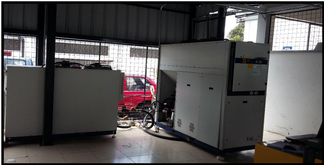
Figura 70. Distribución de los chillers en el interior del cuarto de máquinas
