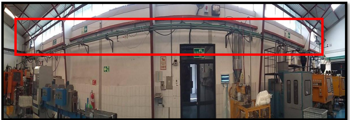
Figura 65. Red hidráulica de enfriamiento en el área de producción
