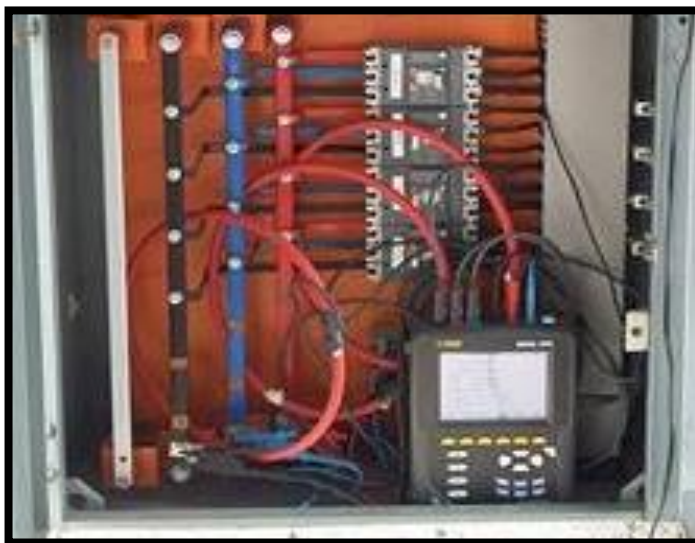
Figura 106. Conexión del analizador de energía
