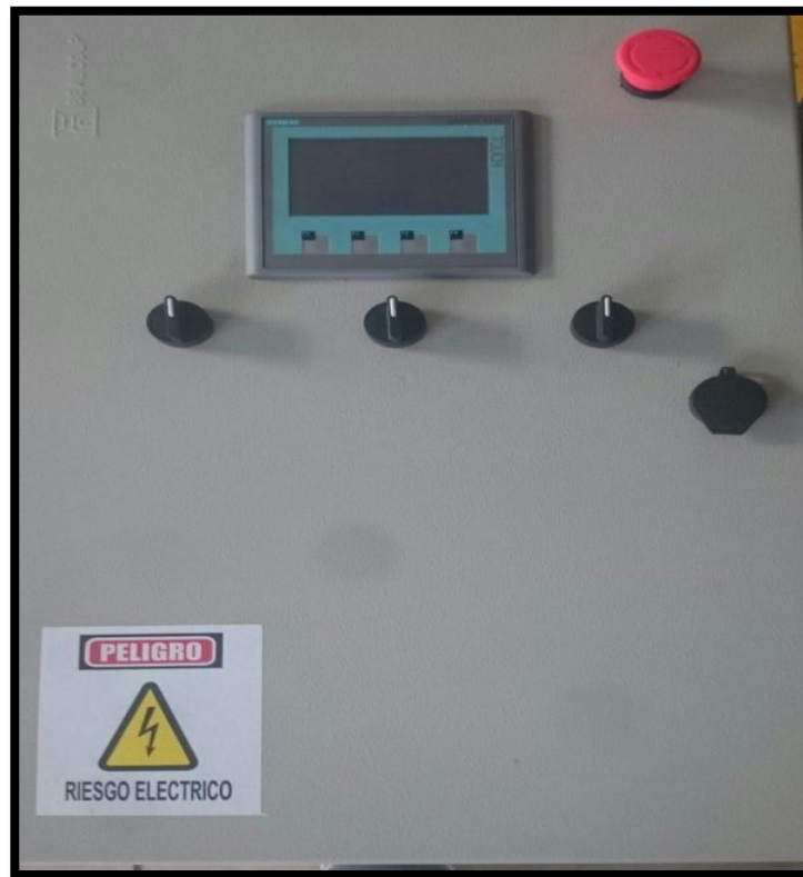
Figura 68. Tablero de control vista frontal
