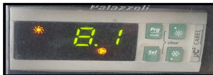
Figura 81. Temperatura de set point para el chiller 2
