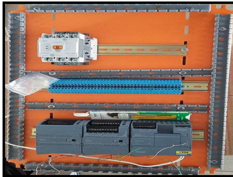
Figura 67. Parte interior del tablero de control
