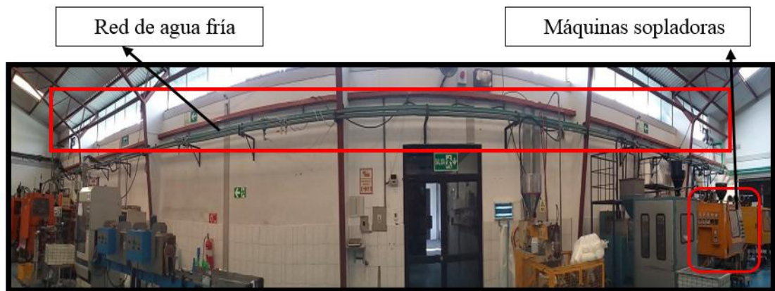
Figura 73. Conexión de la red de enfriamiento
