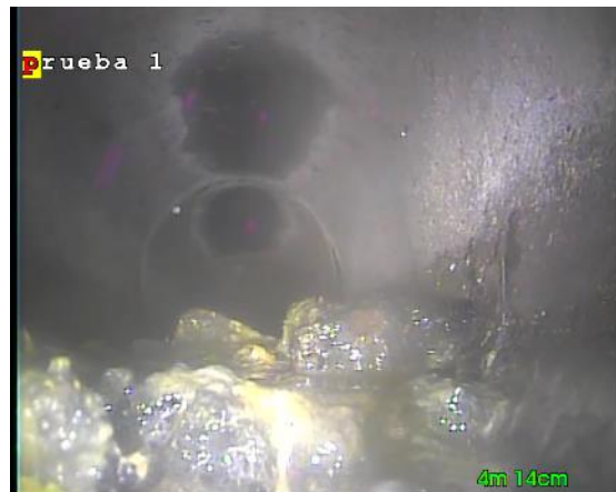
Figura 100. Grasas en redes de alcantarillado pluvial
