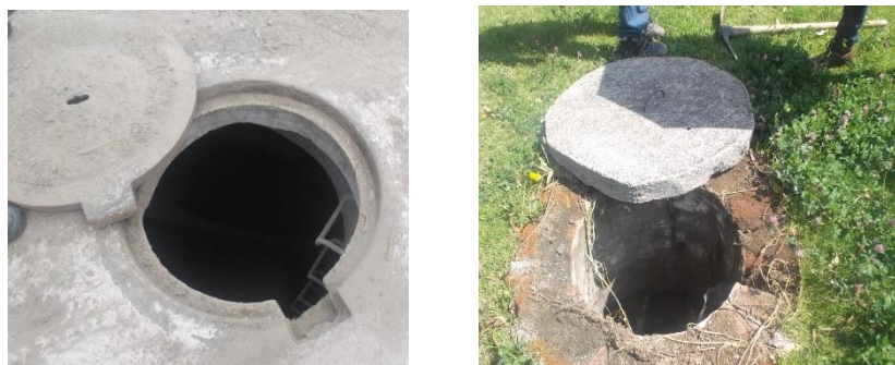
Figura 90. Estado de la tapa del pozo
