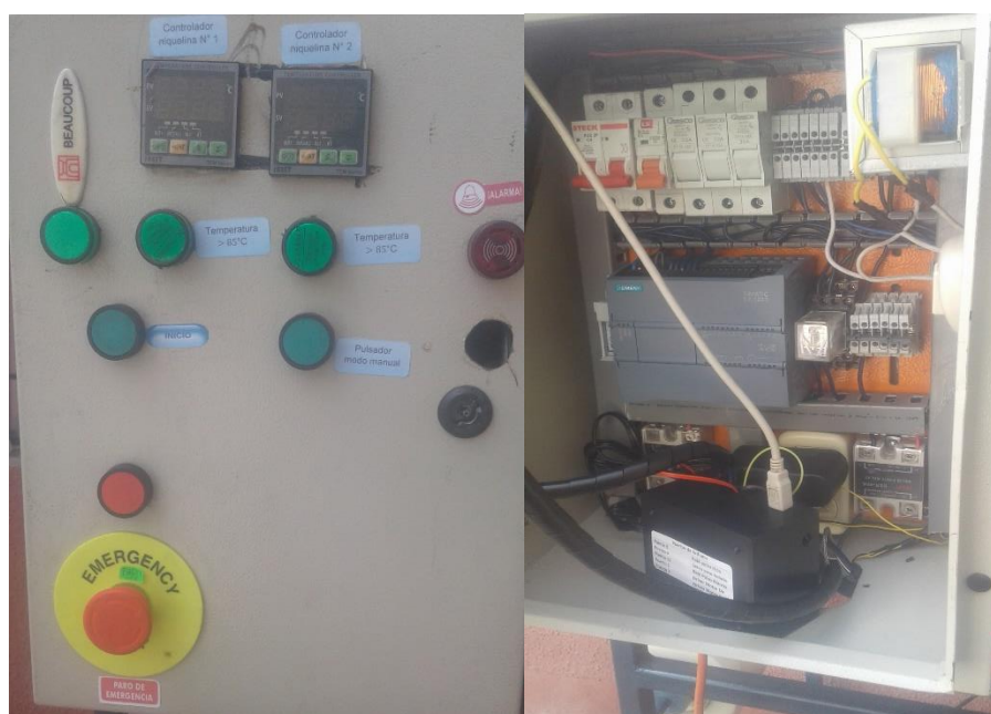
Figura 63 Tablero de control
