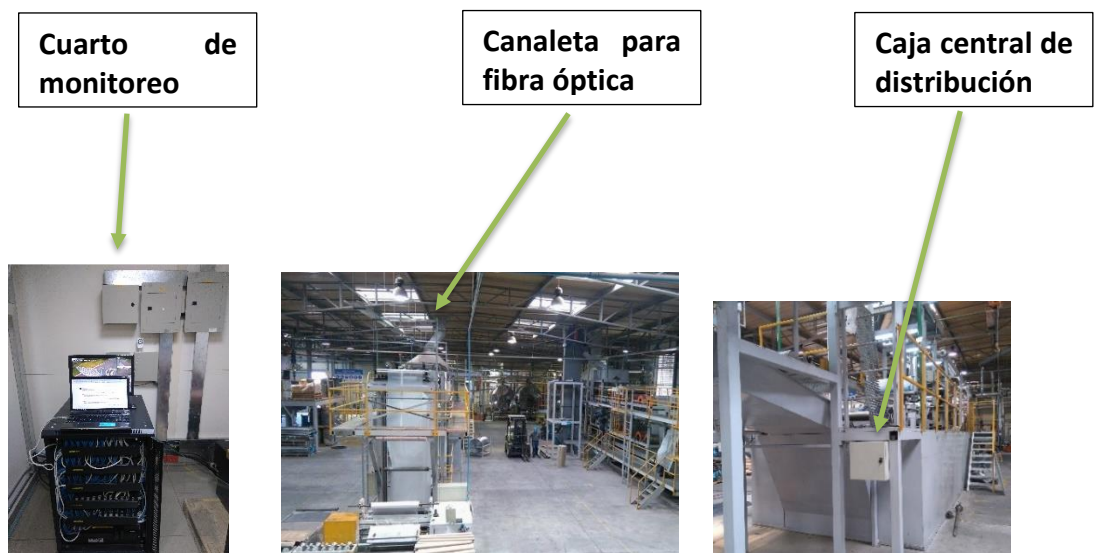
Figura 85: Canalización de fibra óptica hasta la caja central
