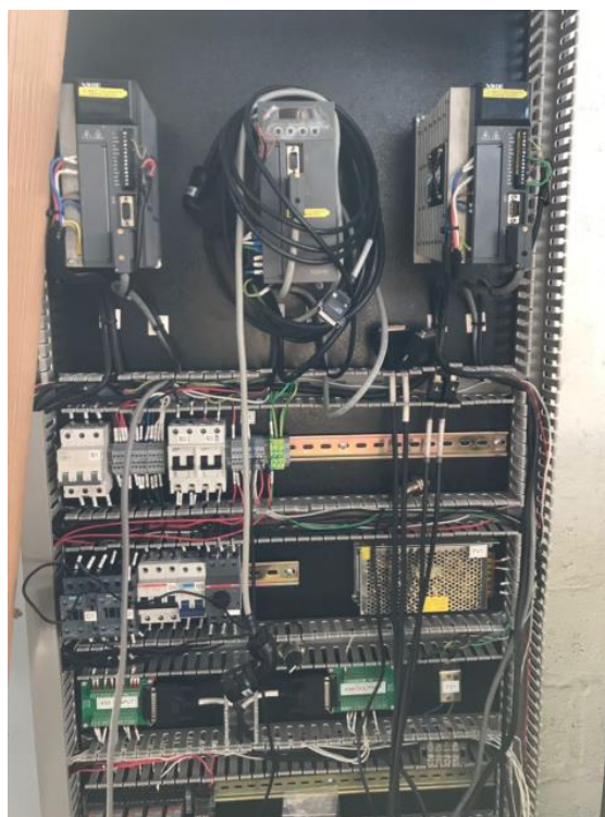
Figura 310 Conexiones del nuevo panel de control
