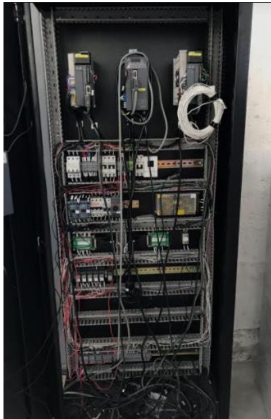
Figura 41 Vista Interior del Actual Tablero de Control
