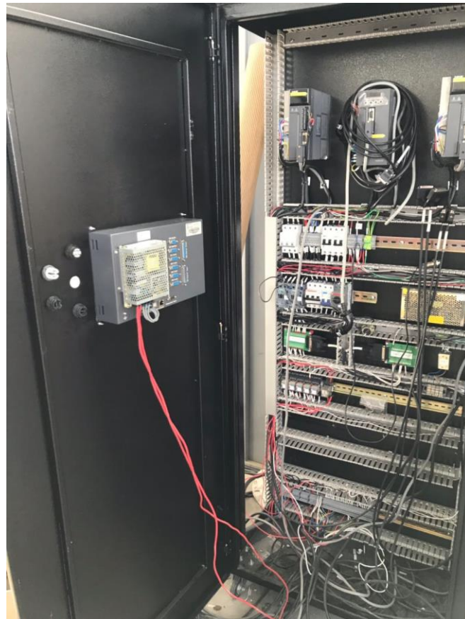
Figura 22 Instalación del controlador CNC NCT-03
