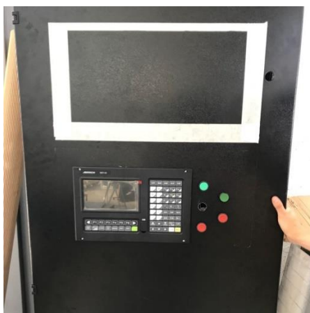
Figura 11 Puerta del panel de Control
