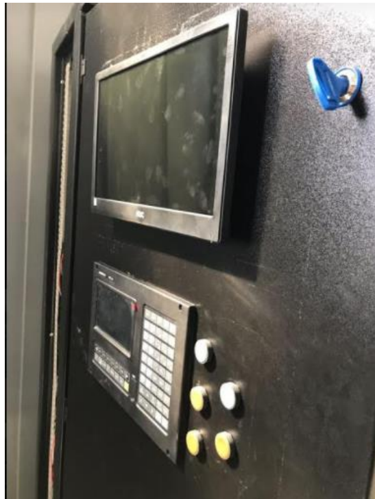
Figura 40 Vista Frontal del Actual Tablero de Control
