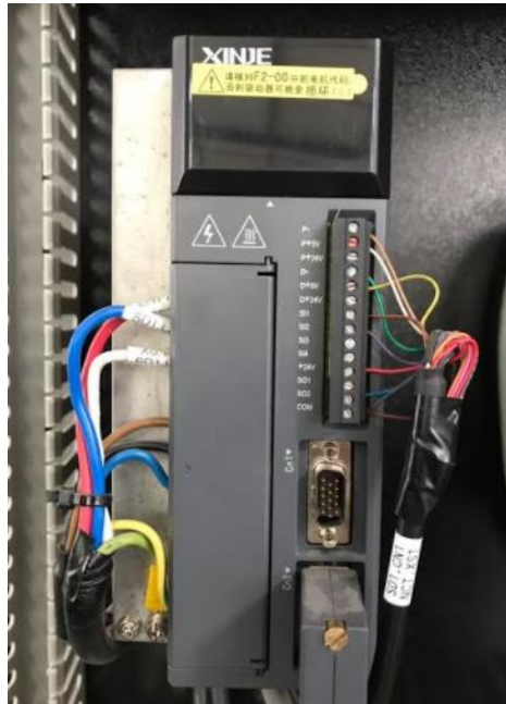
Figura 37 Vista Frontal Controlador Xinje
