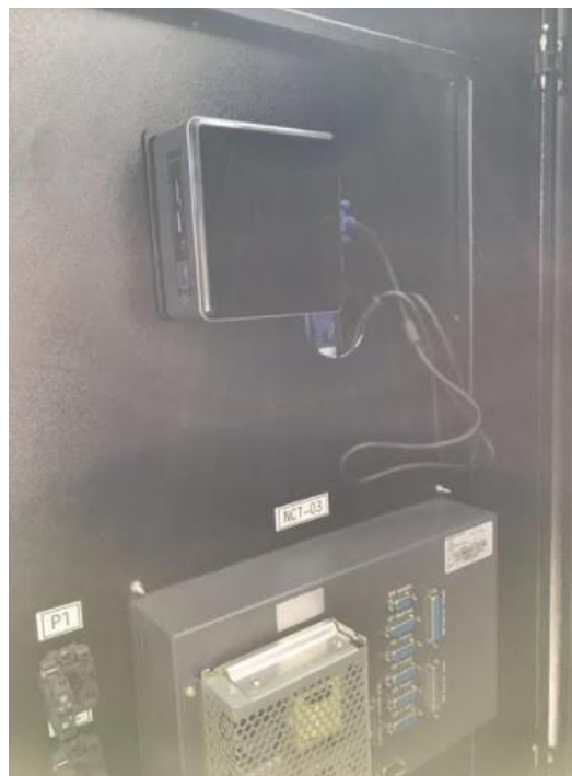
Figura 39 Vista Interior del Nuevo Tablero de Control
