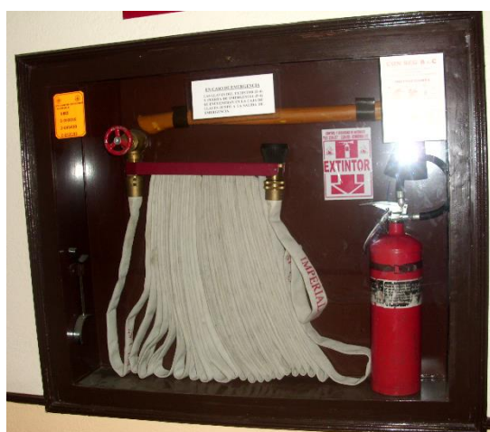
Figura 24 Extintores del Edificio
