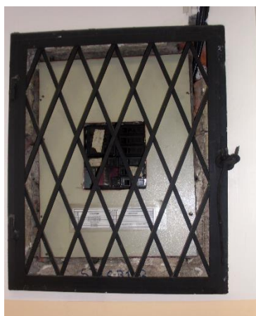
Figura 27 Tablero General Eléctrico
