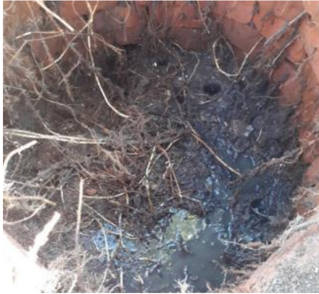
Figura 15. Pozo con acumulación de sedimentos
