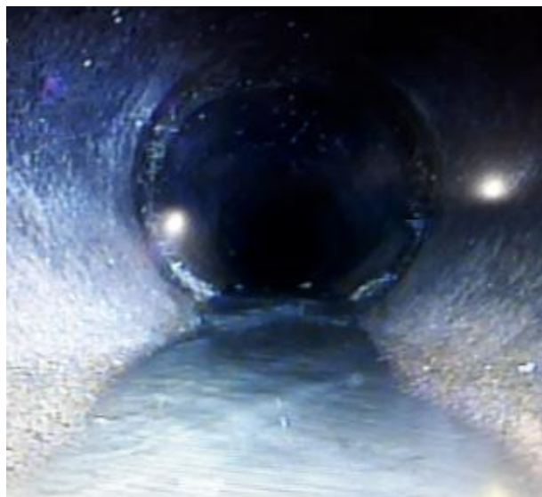
Figura 16. Presencia de rebabas en uniones de tuberías de alcantarillado
