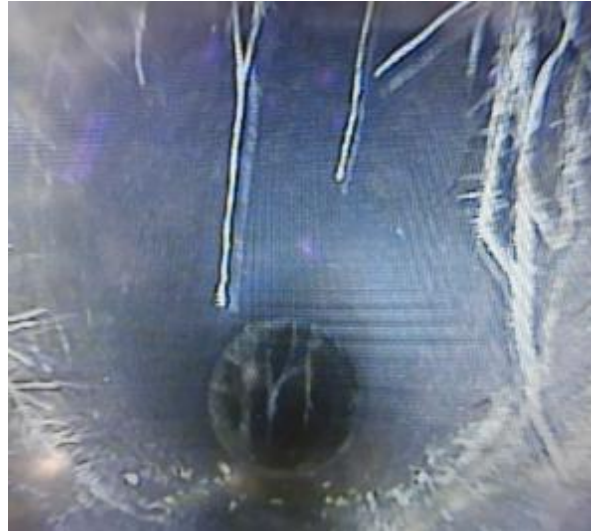
Figura 20. Tubería matriz con raíces
