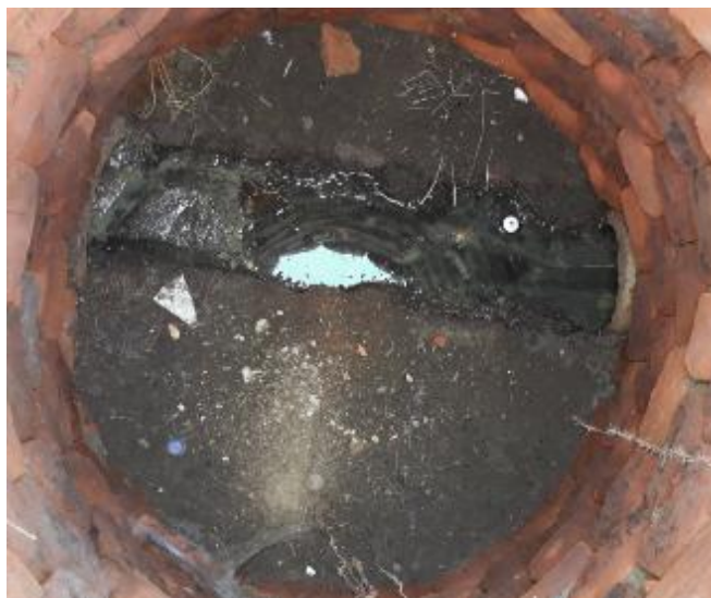
Figura 11. Pozo de ladrillo sin revestimiento
