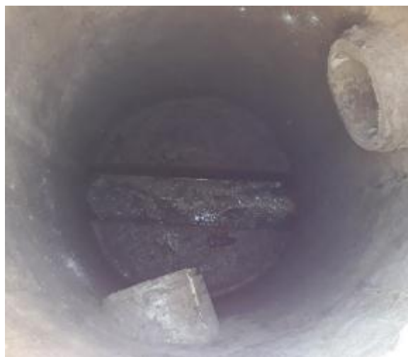
Figura 14. Pozo con tuberías no revocadas
