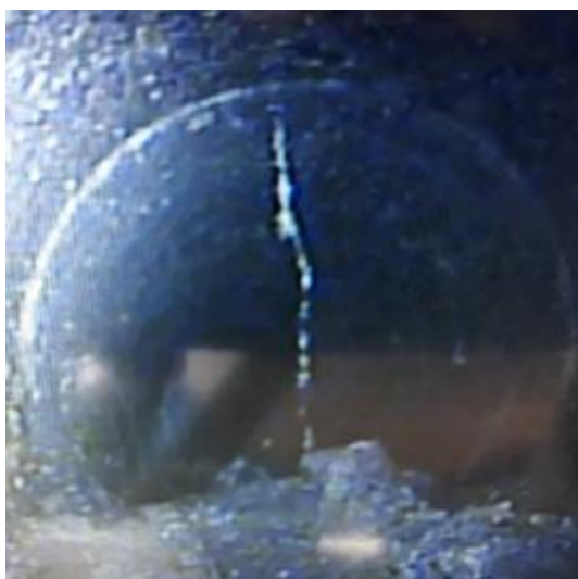
Figura 17. Acumulación de sedimentos en tubería matriz
