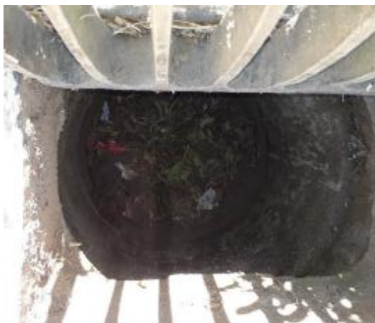
Figura 13. Sumidero sin sifonamiento
