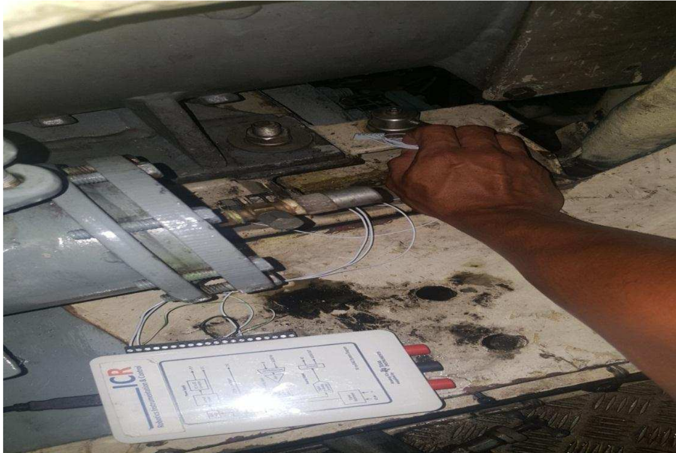
Figura 13: Toma de medidas en la base del compresor - comprobación 2
