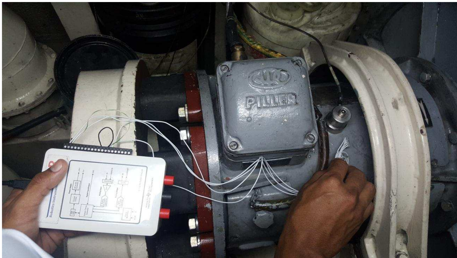
Figura 10: Toma de medidas en el sector de fuerza - comprobación 1
