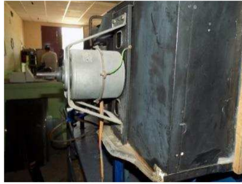
Figura 19 Motor del compresor y del ventilador
