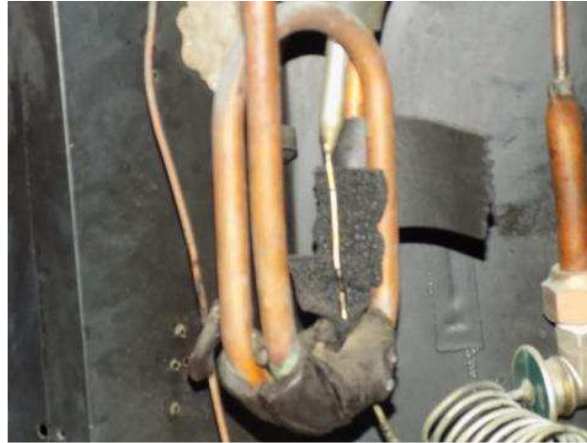
Figura 15 Tubería de cobre para refrigeración, tipo K.
