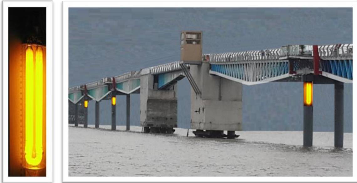
Figura 4.6 Lámparas de Sodio Ubicadas en los Pilares
