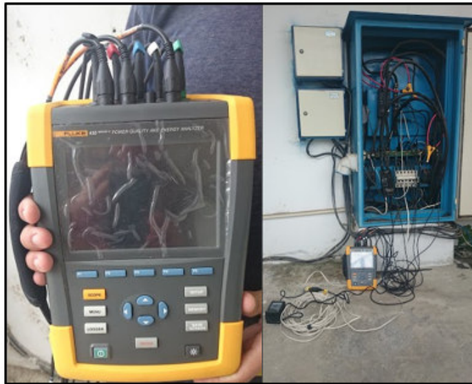
Figura 3.3.1: Equipo de medición FLUKE 430-II conectado en tablero de distribución del Bloque de Abastecimientos. Fuente: Remigio Haro
