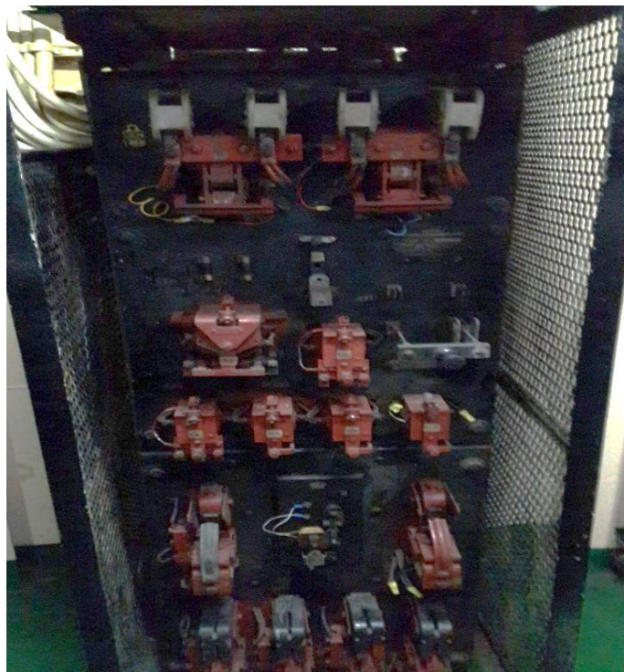
Figura 1.3 Sistema de Arranque del Motor eléctrico de corriente continua del cabrestante del BESMAR.
