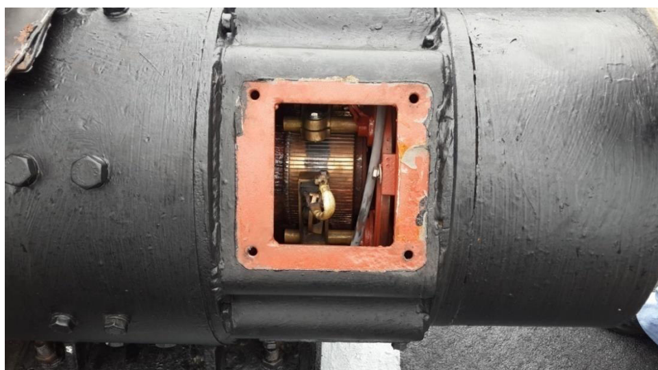
Figura 1.2 Motor eléctrico de corriente continua del cabrestante del BESMAR
