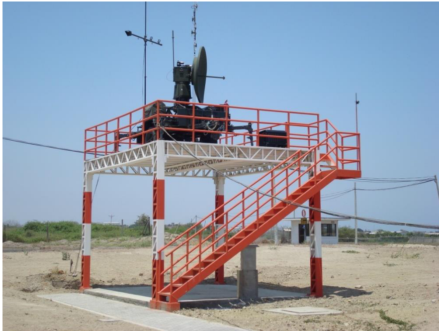
Figura 2.7 Antena de transmisión vista externa
