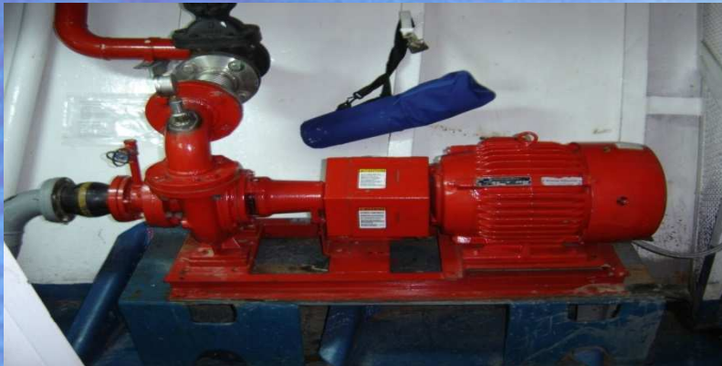
BOMBA CONTRA INCENDIO
