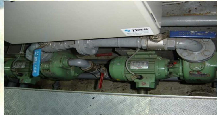
BOMBA DE AGUAS GRISES
