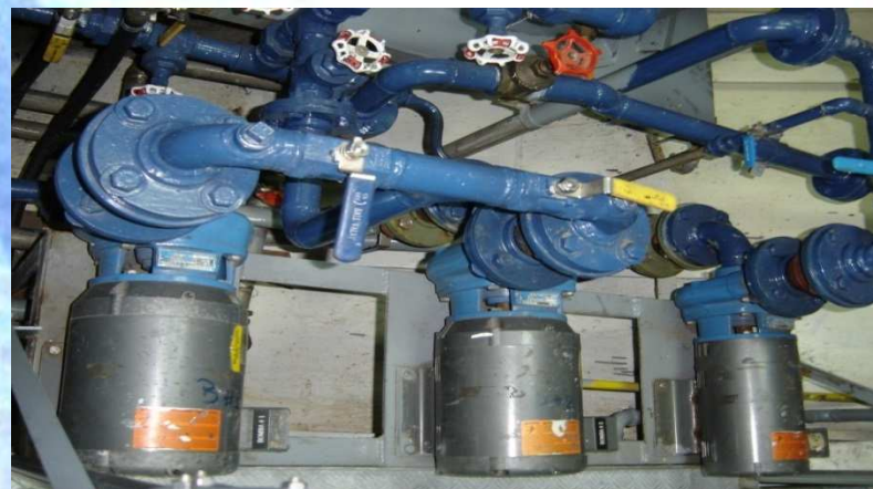
BOMBAS DE AGUA
