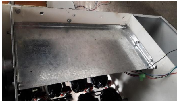
Figura 84 Base de soporte del circuito de control
