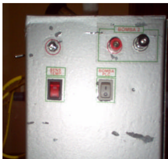
Figura 1.28. Interruptores de Sensores de Temperatura y Tarjeta de Acondicionamiento de las Bombas
