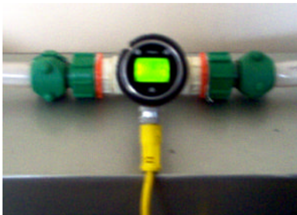
Figura 1.14. Sensor transmisor de caudal
