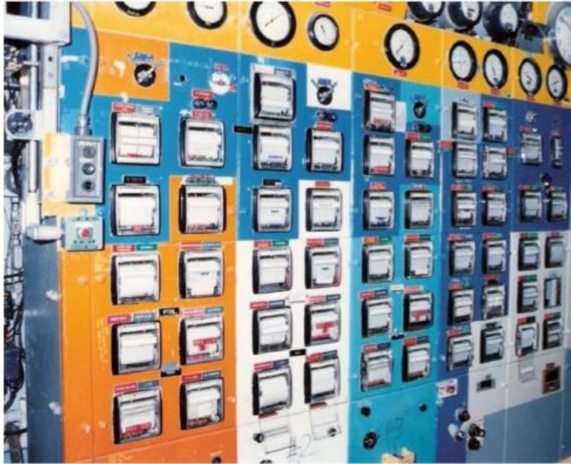
Figura 2. Cuarto de control en el pasado Fuente: (Advanced Control Systems, 2016)
