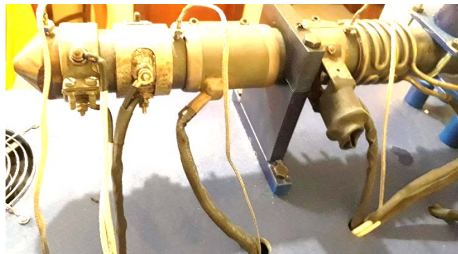
Figura 54. Cables con aislamiento térmico
