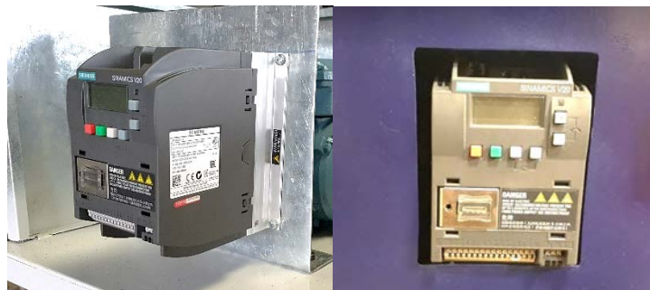
Figura 55. Montaje Variador de Frecuencia
