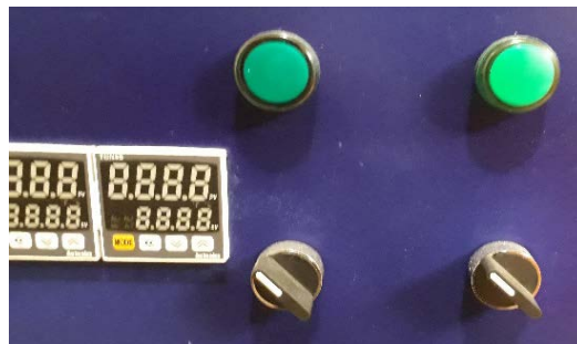
Figura 58. Interruptores y luces piloto de la extrusora
