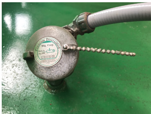
Figura 30. Sensor temperatura cámara secundaria
