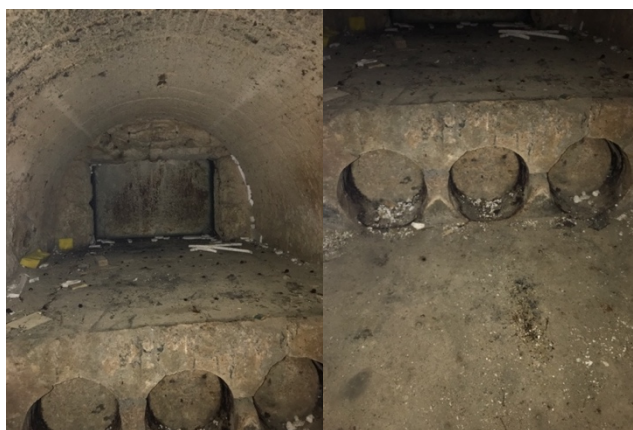
Figura 13. Cámara de combustión primaria
