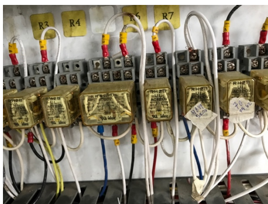
Figura 37. Relay de protección.
