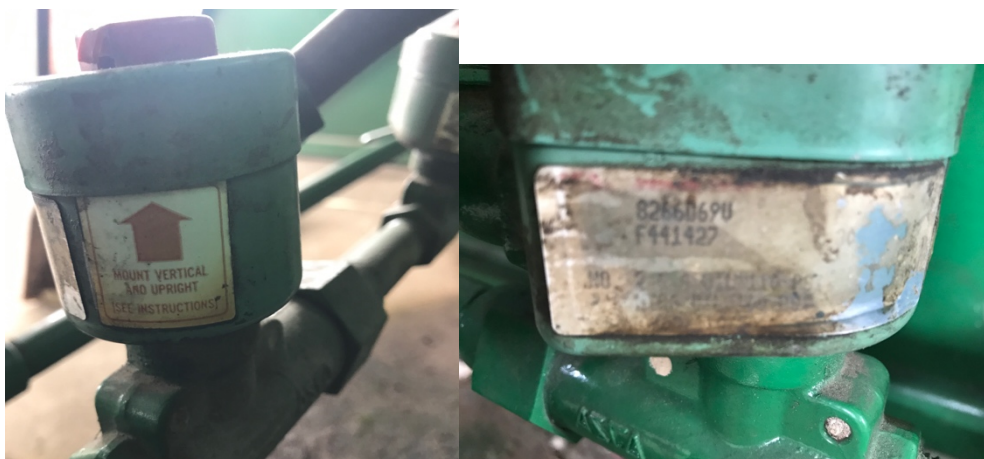
Figura 19. Electroválvulas tren de combustión primario
