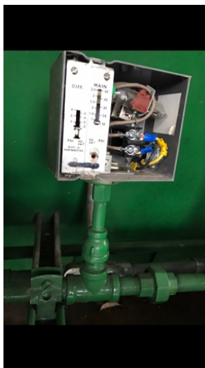
Figura 24. Pressuretrol cámara primaria.
