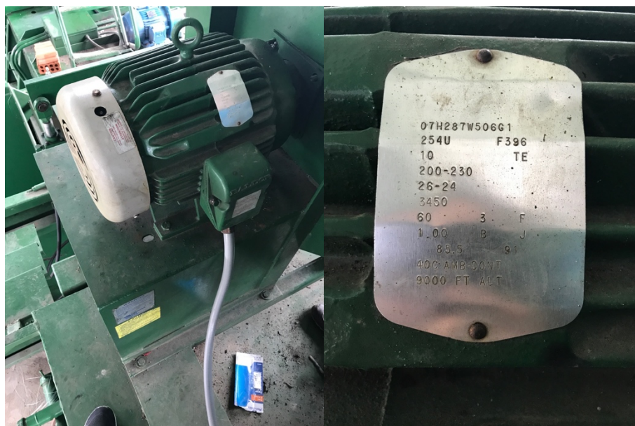
Figura 27. Motor principal cámara secundaria.
