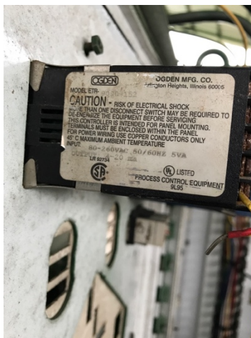
Figura 38. Indicador tren primario de combustión.
