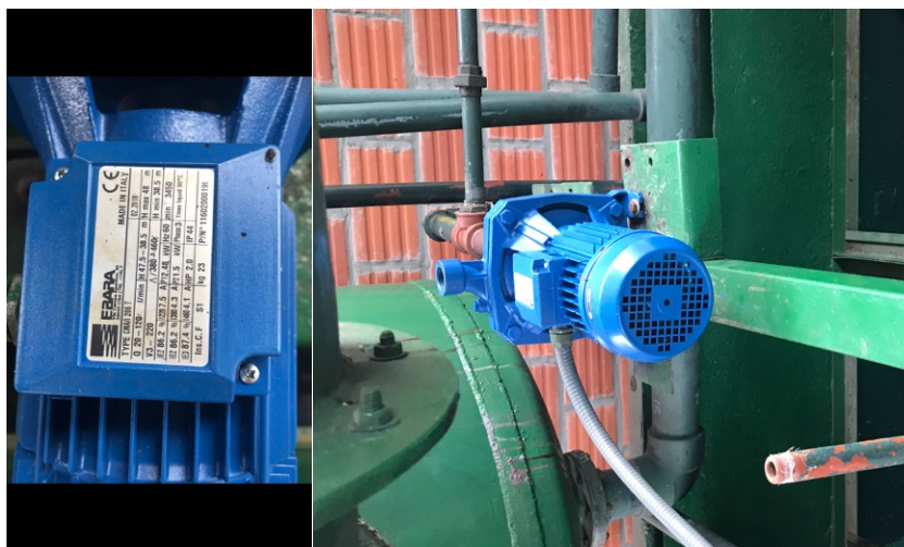
Figura 34. Bomba de inyección de químico, lavador de gases
