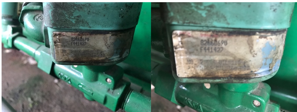
Figura 32. Electroválvulas tren de combustión secundario
