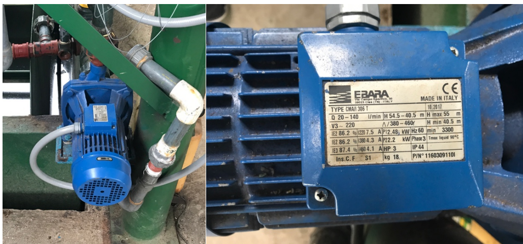
Figura 33. Bomba de agua tanque de licor.
