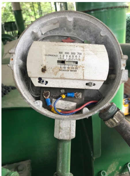
Figura 29. Switch de presión de aire
