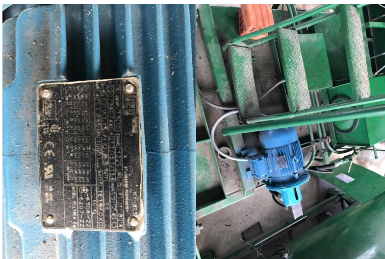
Figura 42. Matrimonio bomba- motor hidráulico
