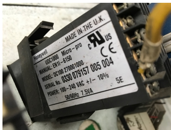
Figura 39. Indicador tren de combustión.
