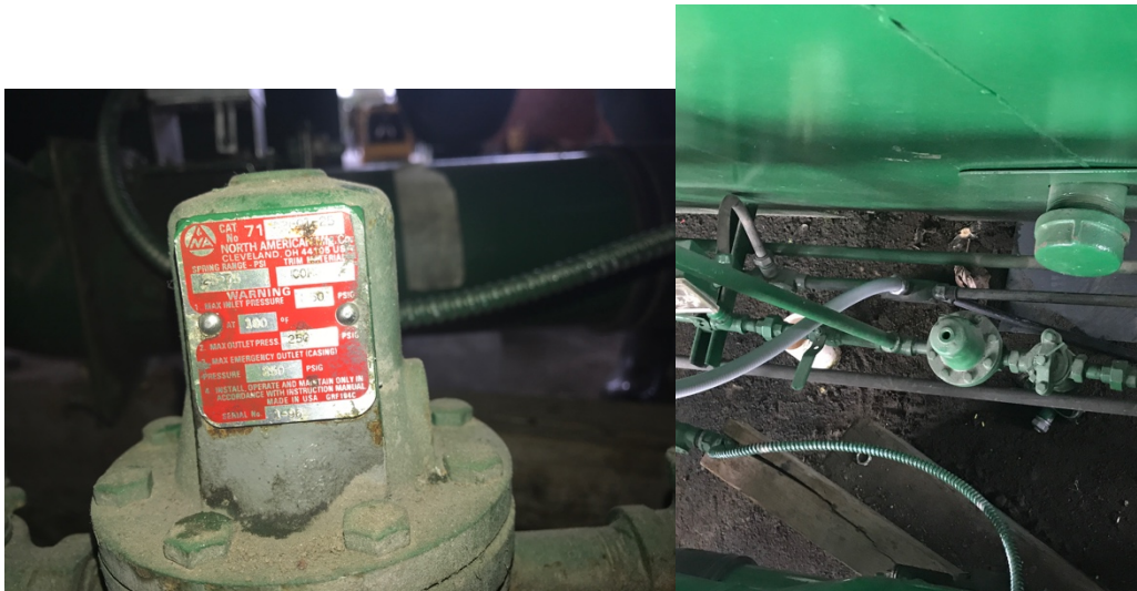
Figura 18. Regulador de presión cámara primaria
