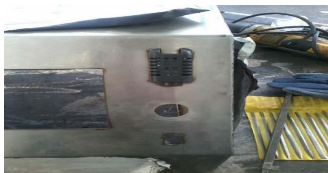
Figura 105: Colocación de sensor de humedad temperatura
