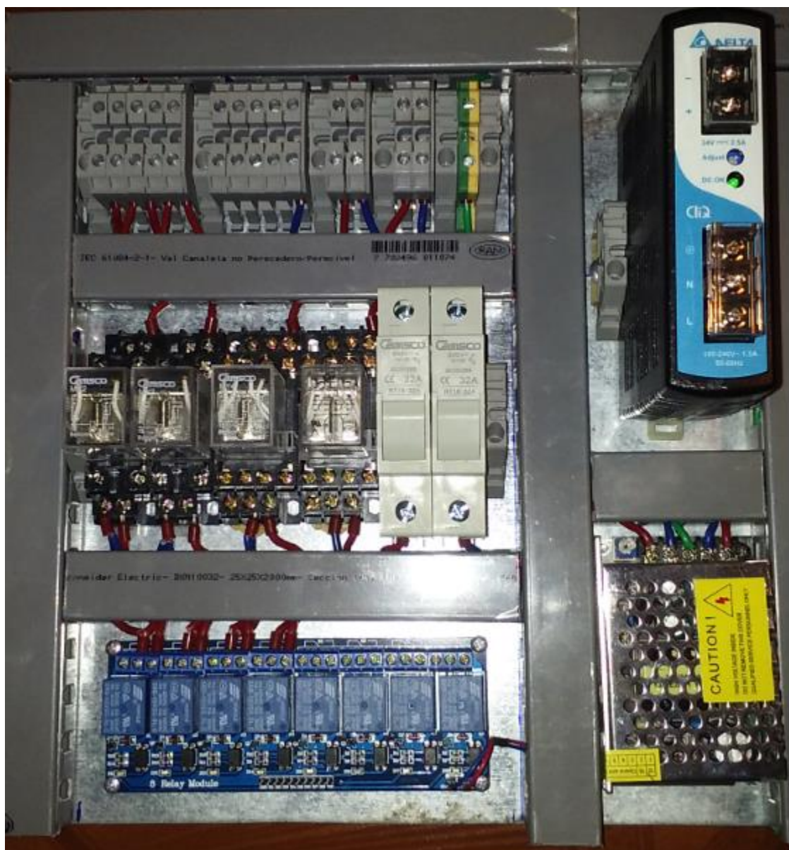
Figura 123: Tablero del Sistema de Control
