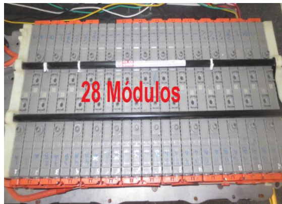
Figura 11. Módulos de la batería de alto voltaje Toyota Prius
