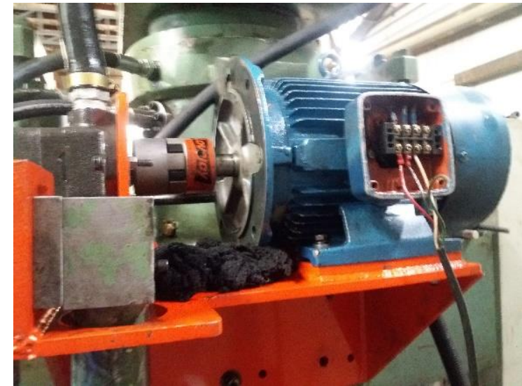
Figura Soporte de la bomba hidráulica
