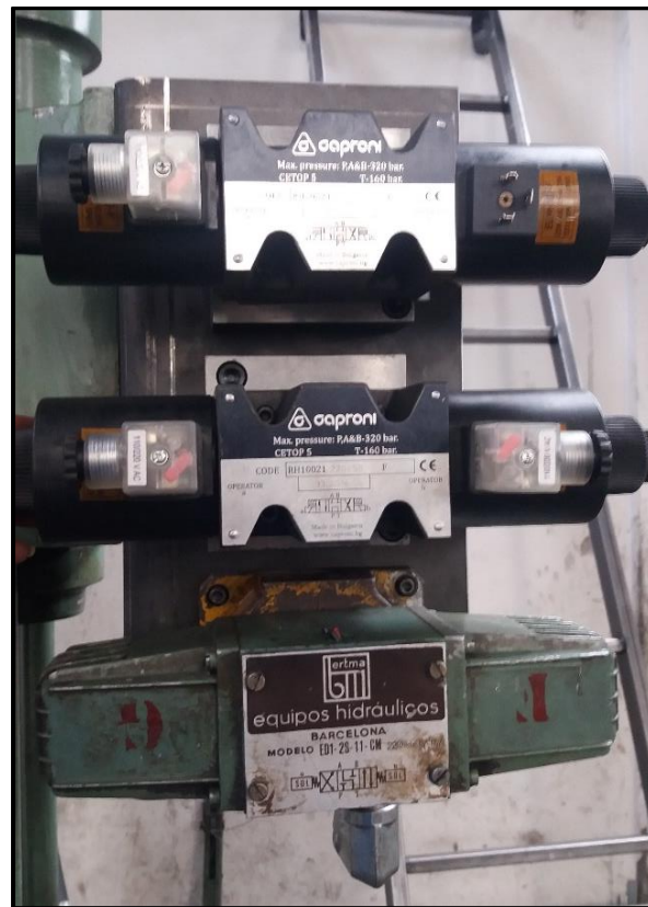
Figura 66. Montaje Electroválvulas direccionales
