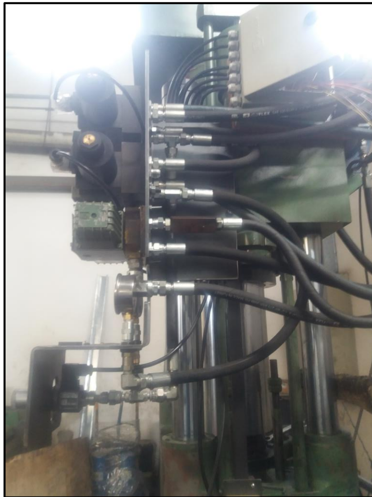
Figura 69. Conexión circuito hidráulico.
