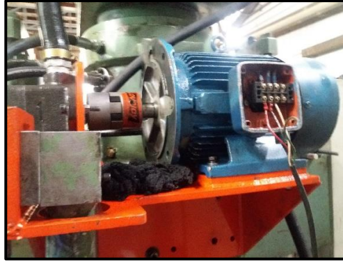
Figura 63. Soporte de la bomba hidráulica
