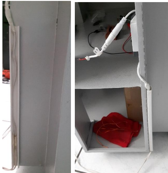
Figura 85. Conexiones eléctricas del sistema de iluminación
