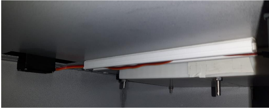
Figura 86. Canaletas para ocultar el cableado del elemento de sujeción de piezas
