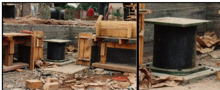
Figura 1.11 Aislador sísmico Edificio Andalucía
