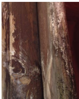
Figura 22 Presencia hongos cromógenos en la superficie de la madera
