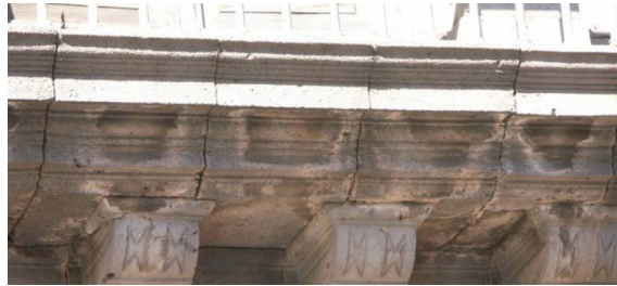
Figura 44 Eflorescencia en piedra
