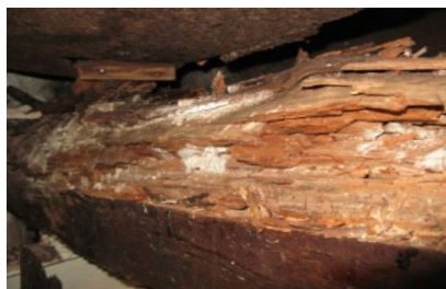
Figura 24 Ejemplo de pudrición parda en una viga de madera
