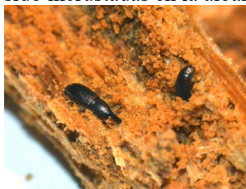
Figura 29 Presencia de gorgojo en la madera
