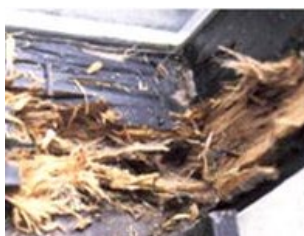
Figura 25 Presencia de hongos xilófagos, pudrición blanda
