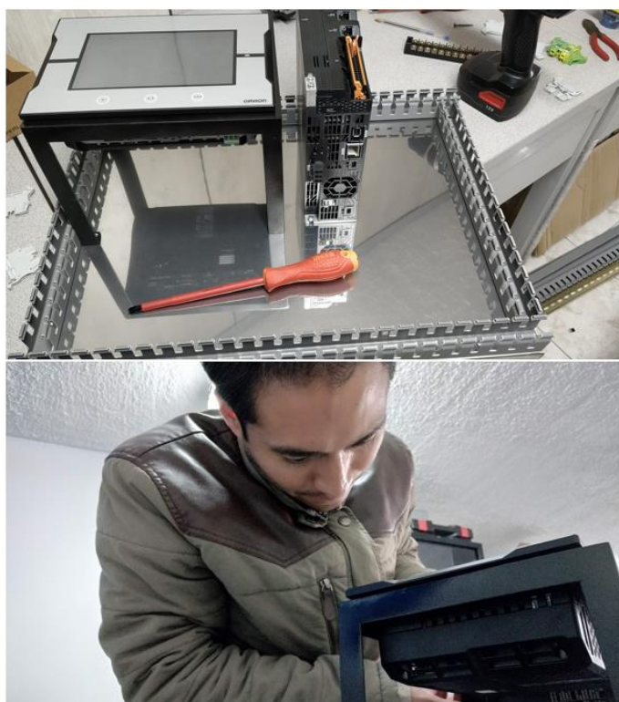
Figura 47. Base metálica de los HMIs
