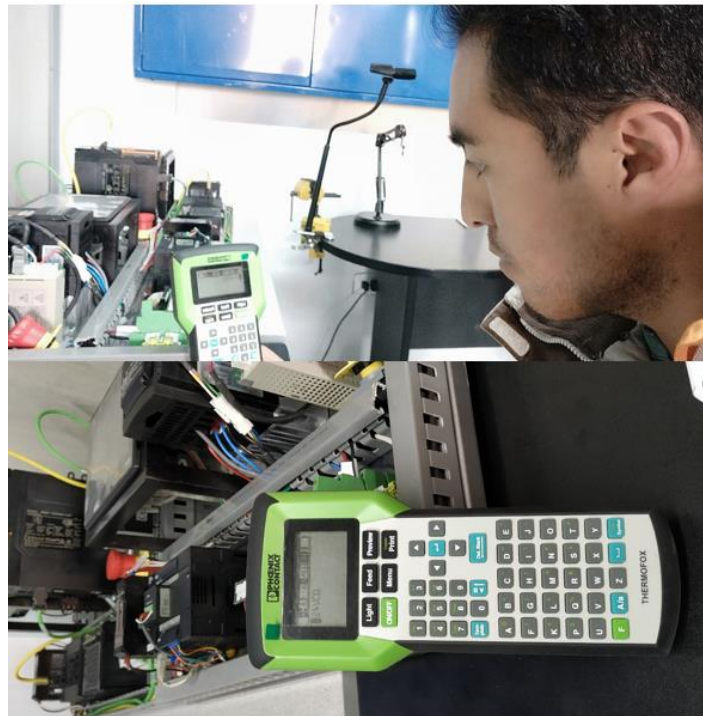
Figura 52. Impresión de etiquetas para identificación de conexiones
