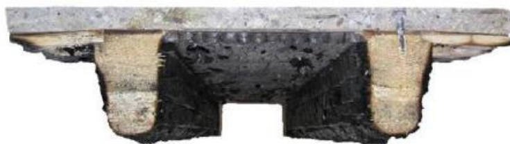
Figura 90 Vigas de madera parcialmente carbonizadas tras incendio. Por fuera aparentan estar totalmente quemadas, pero se conserva su sección.
