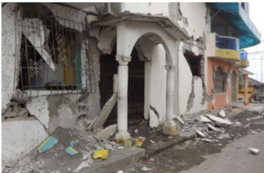
Figura 3 Hotel Fogón Manabita, en el malecón de Tonsupa, presenta fisuras, grietas y colapso de paredes de mampostería Fuente: (Bonilla, 2016)
