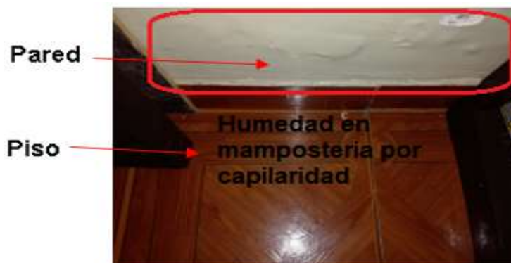
Figura 113 Daños en mampostería por humedad en la vivienda de la Sra. Matilda Sarabia.
