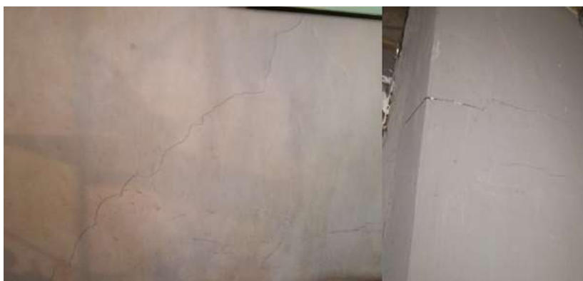
Figura 95 Presencia de grietas en mampostería interna, vivienda de la Sra. Marlene Campos Pereira.
