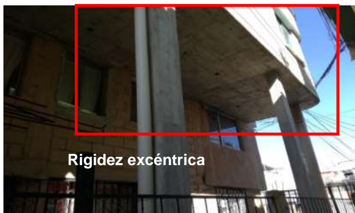
Figura 48 Irregularidad torsional en la vivienda del Sr. Servio Guzmán Erazo
