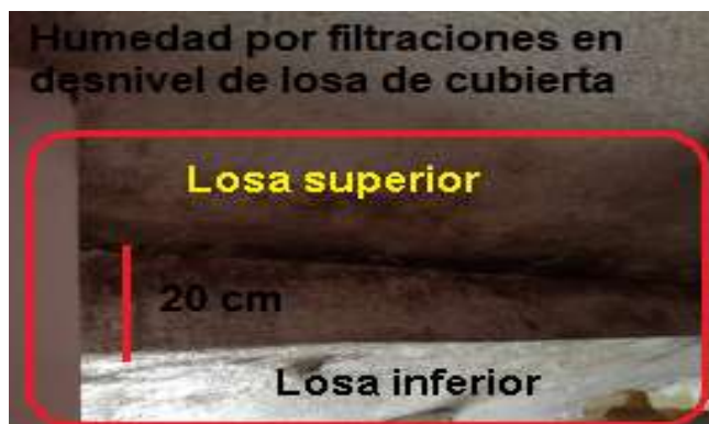
Figura 115 Humedad por filtración en losa de cubierta en la vivienda de la Sra. María Bastidas.
