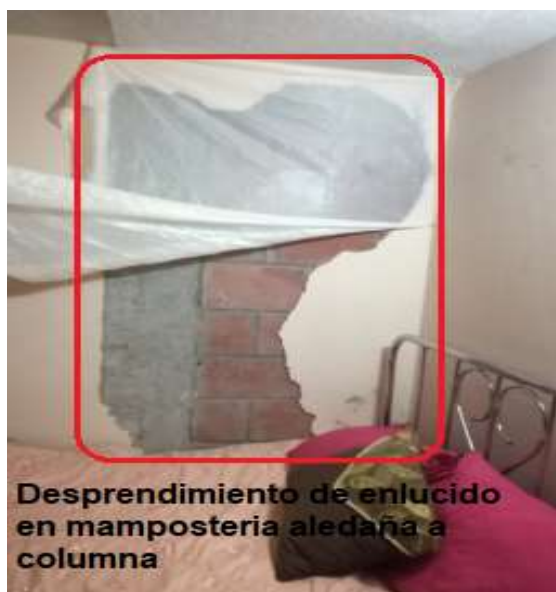
Figura 120 El desprendimiento del enlucido en la mampostería de la vivienda del Sr. Ángel Valdiviezo.
