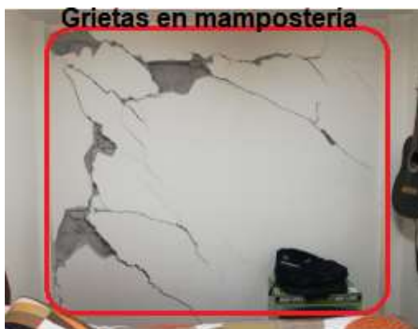
Figura 122 Grietas en la mampostería en la vivienda del Sr. Augusto Tenesaca.
