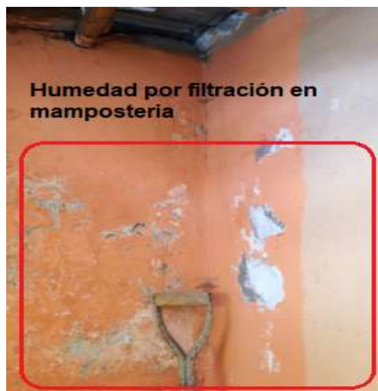
Figura 117 Humedad por filtración en la vivienda del Sr. Luis Gallardo.
