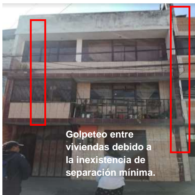
Figura 66. Golpeteo presente en la vivienda de la Sra. Marlene Campos Pereira.
