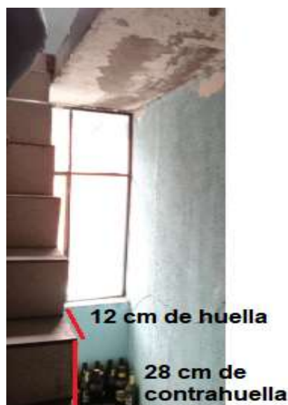
Figura 142. Gradas irregulares en la vivienda del Sr. Varela.
