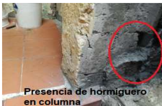
Figura 132 Presencia de hormiguero en una columna en la vivienda de la Sra. Maricela Flores.
