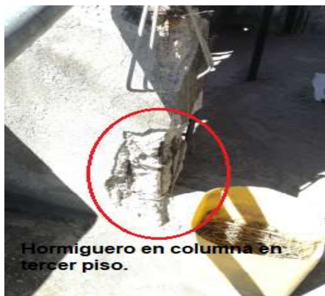
Figura 129 Presencia de hormiguero en una columna, en la vivienda del Sr. Ángel Valdiviezo.
