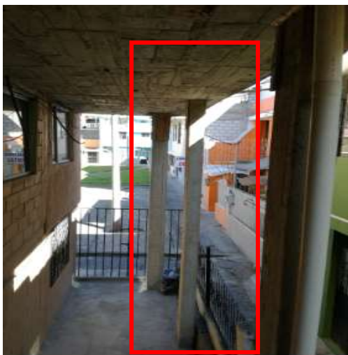
Figura 38 Piso blando en la vivienda del Sr. Servio Guzmán Erazo
