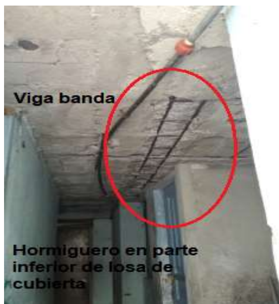
Figura 130 Presencia de hormigüero en la parte inferior de la losa de cubierta en la, vivienda del Sr. Diógenes Varela.
