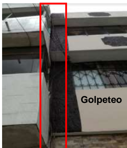
Figura 140 Golpeteo vivienda Sr. Eduardo Villamar.
