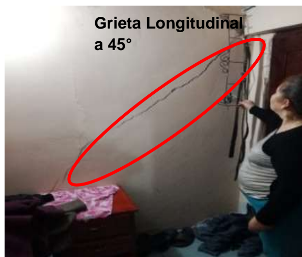
Figura 102. Grieta longitudinal vivienda del Sr. Ángel Valdivieso.
