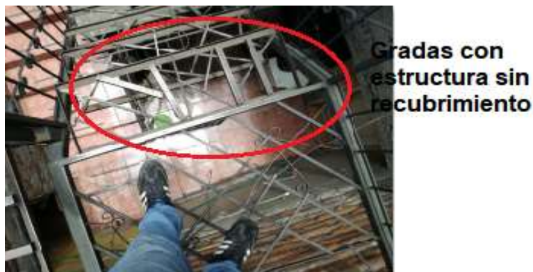
Figura 143 Gradas con estructura sin recubrimiento en la vivienda de la Sra. Maricela Flores.
