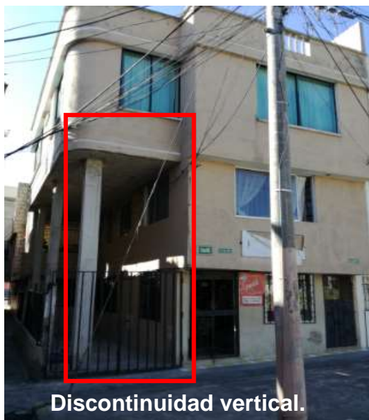
Figura 37. Discontinuidad vertical en la vivienda del Sr. Servio Guzmán Erazo.
