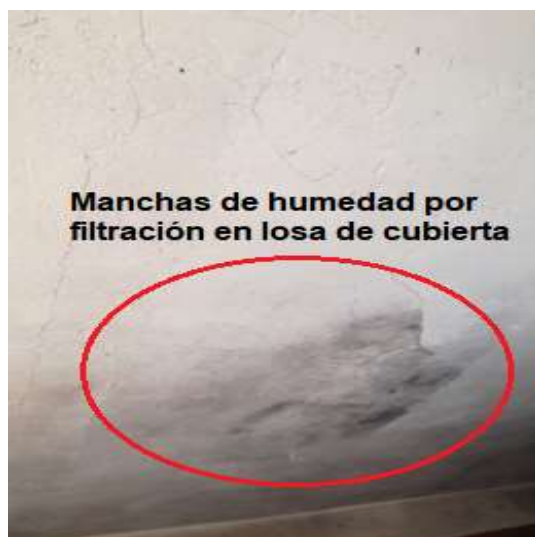
Figura 111 Humedad por filtración en la vivienda de la Sra. Martha Pucó.
