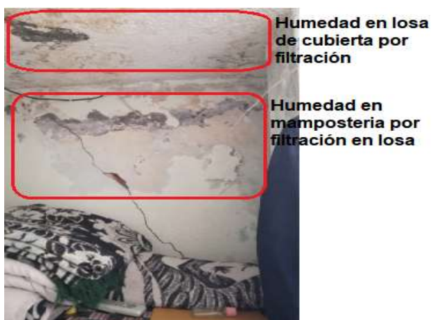
Figura 114 Humedad por filtración y falta de mantenimiento en la vivienda del Sr. Diógenes Varela.
