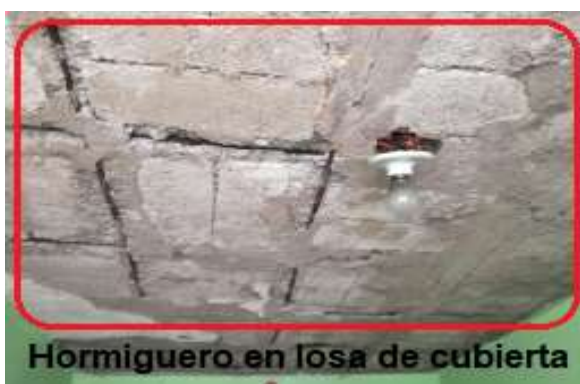
Figura 131 Presencia de hormigüero en la parte inferior de la losa de cubierta en la, vivienda del Sr. Diógenes Varela.
