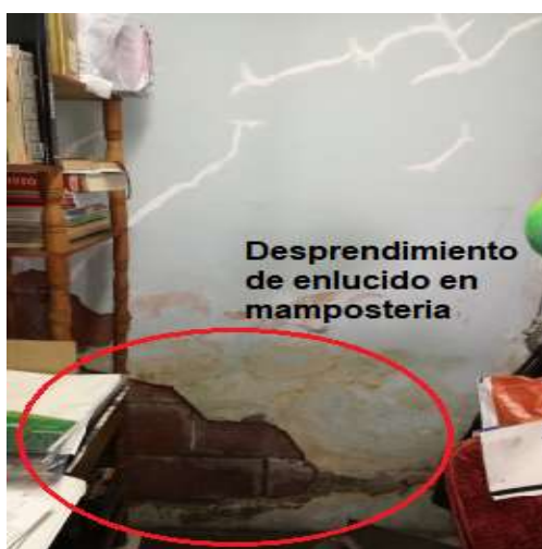
Figura 110 Desprendimiento de enlucido en la vivienda del Sr. Gerardo Toapanta.
