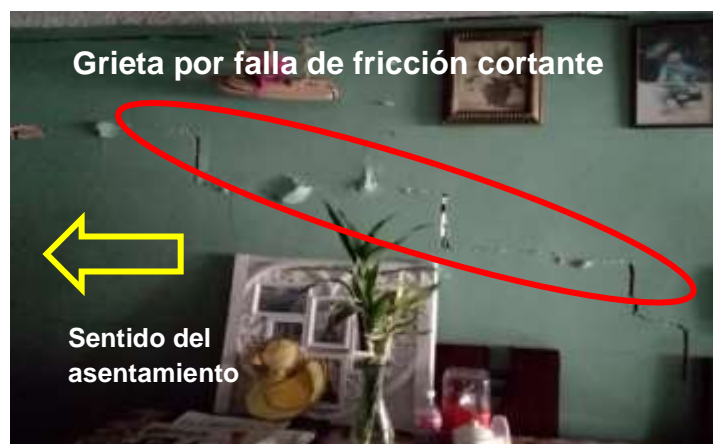
Figura 105 Grieta por falla de fricción cortante vivienda Sr. Nelson Guzmán.
