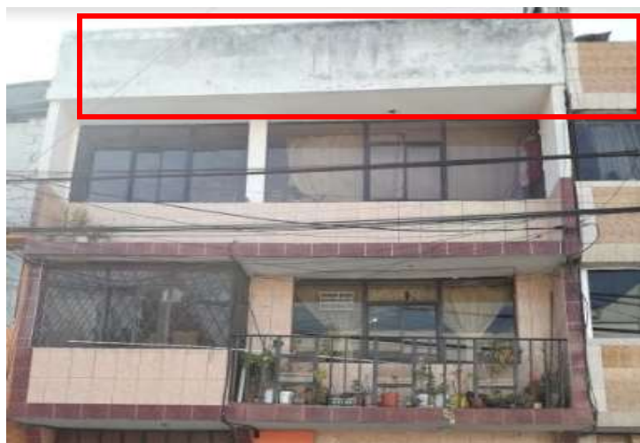
Figura 69. Parapetos en la fachada de la vivienda de la Sra. Marlene Campos.
