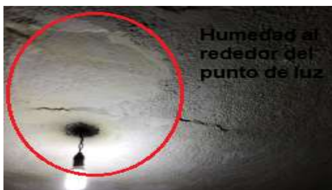
Figura 116 Humedad producida por la filtración en la vivienda de la Sra. Laura Barrionuevo.
