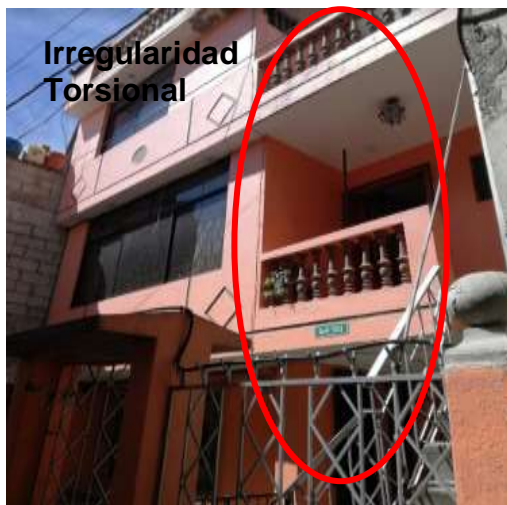
Figura 125 Irregularidad torsional vivienda Sr. Luis Borja.
