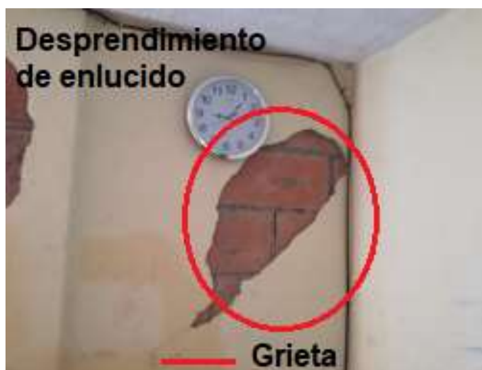
Figura 123 Desprendimiento del enlucido en la mampostería de la vivienda del Sr. Luis Zambrano.
