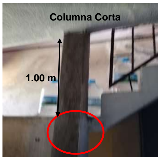
Figura 137 Columna corta vivienda del Sr. Segundo Mora.
