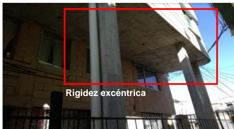
Figura 39 Irregularidad torsional en la vivienda del Sr. Servio Guzmán Erazo
