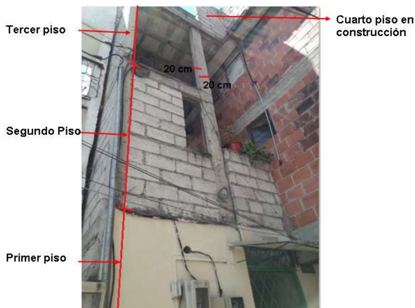
Figura 139 En la vivienda de la Sra. Verónica Torres, se tienen columnas de sección deficiente.
