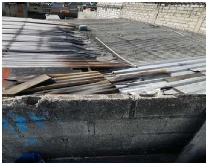
Figura 94 Distribución de masas no uniforme e irregularidad geométrica, vivienda de la Sra. Marlene Campos Pereira
