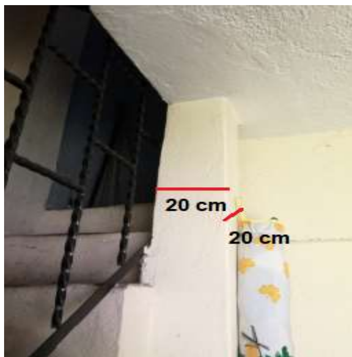
Figura 138 En la vivienda del Sr. Segundo Mora, se aprecia una columna corta.
