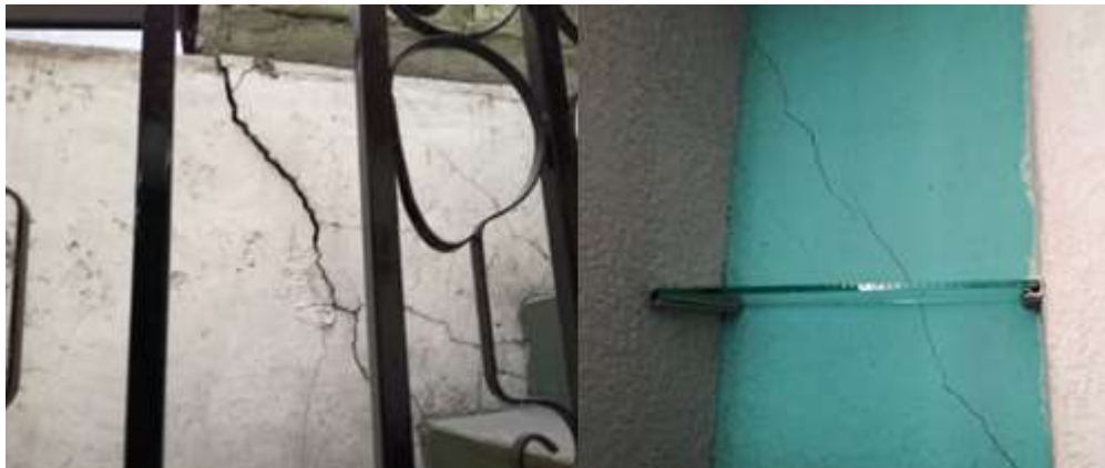
Figura 90. Presencia de grietas en mampostería, vivienda del Sr. Servio Guzmán Erazo
