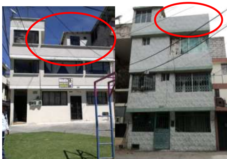
Figura 119 Irregularidad geométrica en planta alta.
