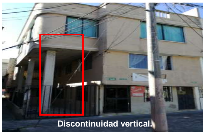
Figura 45. Discontinuidad vertical en la vivienda del Sr. Servio Guzmán Erazo.
