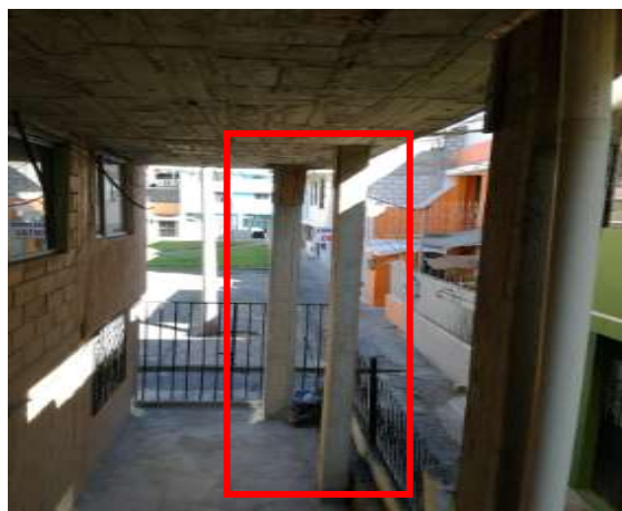
Figura 46 Piso blando en la vivienda del Sr. Servio Guzmán Erazo
