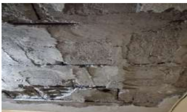
Figura 133 Presencia de hormiguero en la parte inferior de la losa de cubierta en la vivienda del Sr. Rigoberto Proaño.
