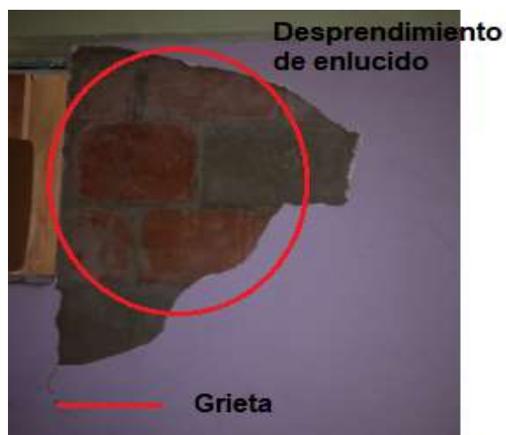
Figura 121 Desprendimiento del enlucido en la mampostería de la vivienda del Sr. Diógenes Varela.
