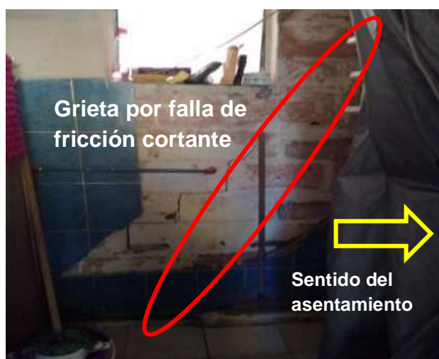
Figura 104. Grieta por falla de fricción cortante vivienda Sra. Luz Jiménez.
