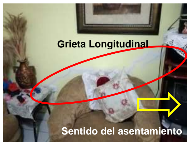
Figura 101. Grieta longitudinal vivienda del Sr. Cesar Villacís.
