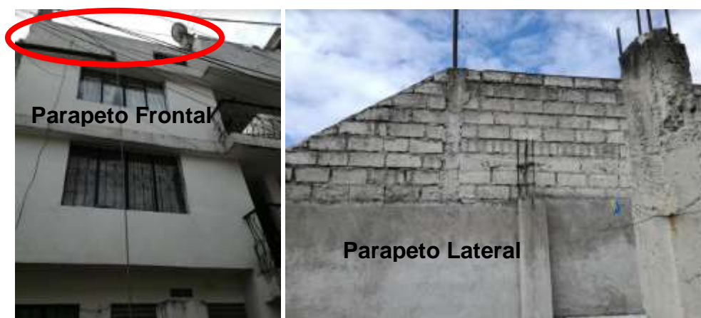
Figura 128. Parapetos de mampostería no reforzada vivienda Sra. María López.
