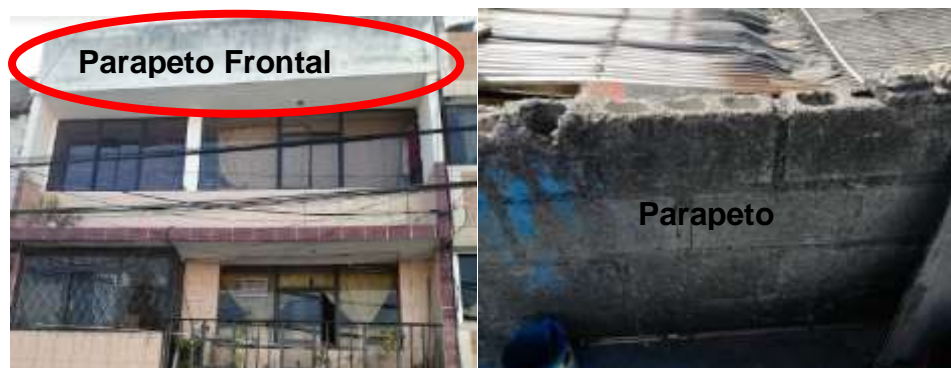
Figura 127. Parapetos de mampostería no reforzada vivienda Sra. Marlene Campos.
