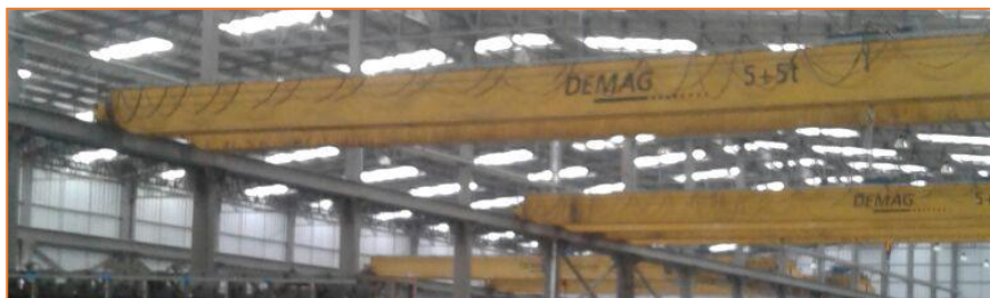
Figura 23. Puente Grúa de 5 + 5 t (10 toneladas)
