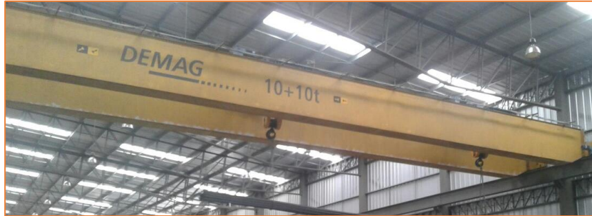
Figura 24. Puente Grúa de 10 + 10 t (20 toneladas)
