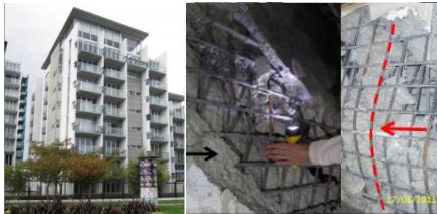
Figura 10: Falla en el muro del piso inferior por pandeo lateral, en la zona inferior del muro Fuente: (Bonelli, Restrepo, Quintana Gallo, Pampanin, & Carr, 2012)
