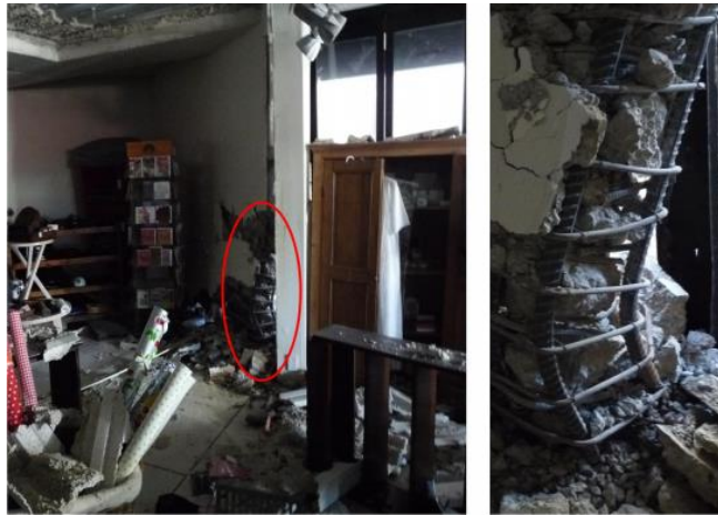
Figura 8: Pandeo local de un muro en L Fuente: (Sri Sritharan,2011)
