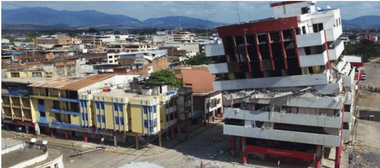
Figura 5: El edificio donde funcionaba la Mutualista Pichincha en Portoviejo muestra los efectos que causó en su estructura el terremoto, en el cual los pisos superiores aplastaron a los pisos inferiores
