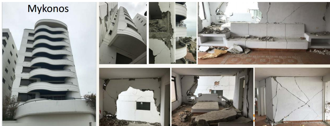
Figura 11: Edificio Mykonos en Manabí, Ecuador, afectado por el colapso de mampostería Fuente: (Sánchez, 2017)
