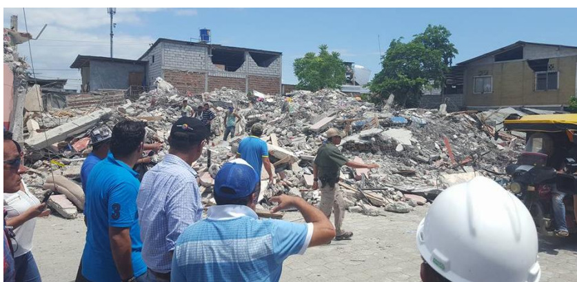
Figura 2. Construcciones caídas tras el terremoto en Pedernales.
