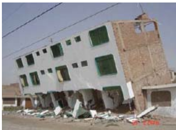
Figura 4.31 Colapso por problema de piso blando. 33
