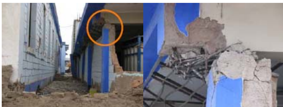
Figura 4.23 Falla por columna corta en el Hospital San Juan de Dios - Ica 31
