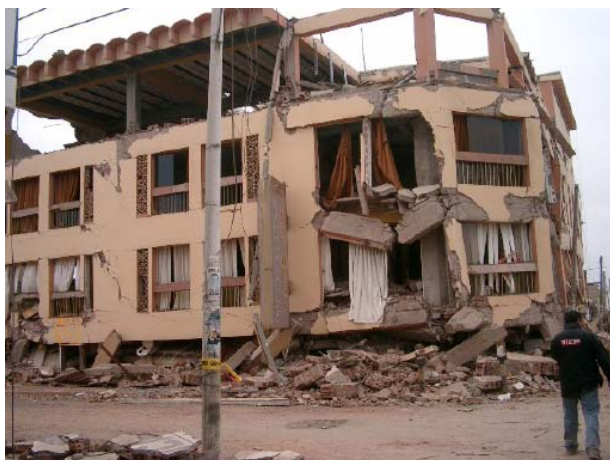
Figura 4.30 Colapso del Hotel Embassy por piso blando (Pisco) 32
