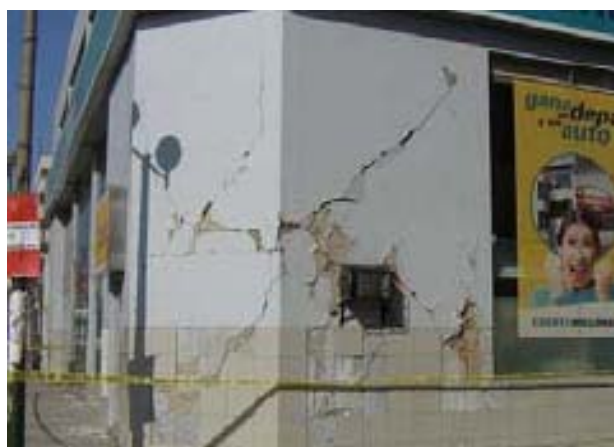
Figura 4.39 Falla por tracción diagonal - Ica 37
