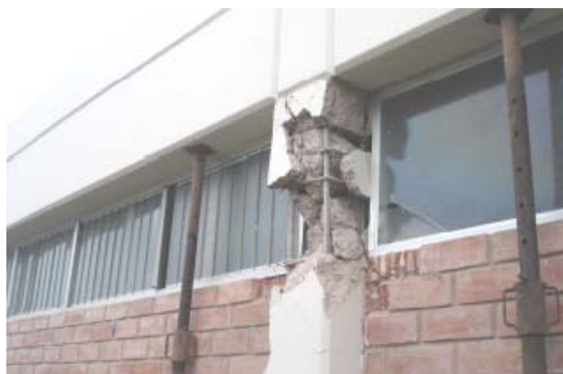
Figura 4.22 Falla por columna corta en Pisco 30
