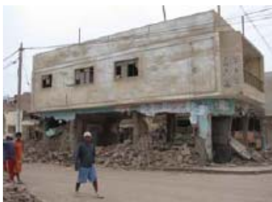
Figura 4.32 Edificio a punto de colapsar por piso blando (Pisco) 34
