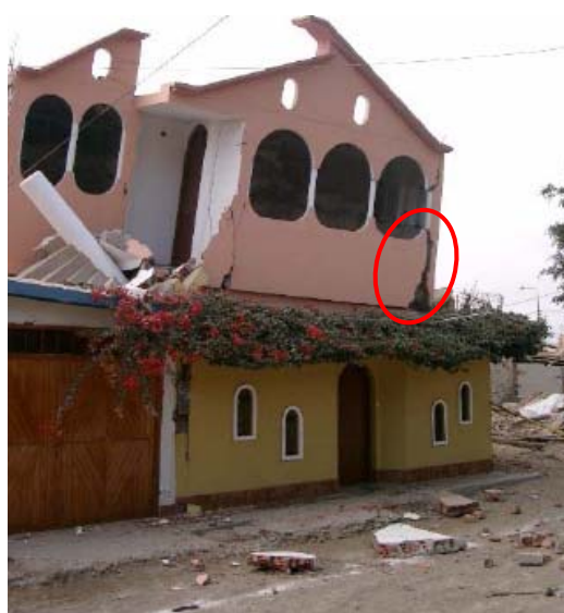
Figura 4.41 Falla por aplastamiento en la esquina inferior - Pisco 39
