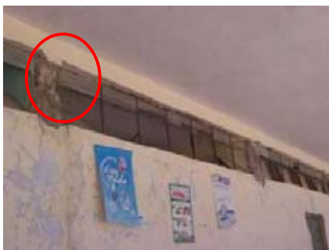
Figura 4.21 Falla por columna corta en el Colegio Nacional 9 de Diciembre en Coracora 29
