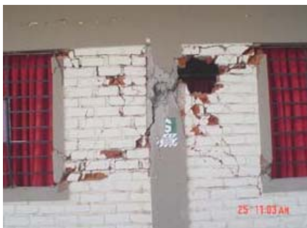
Figura 4.38 Falla por aplastamiento en esquina superior - Ica 36
