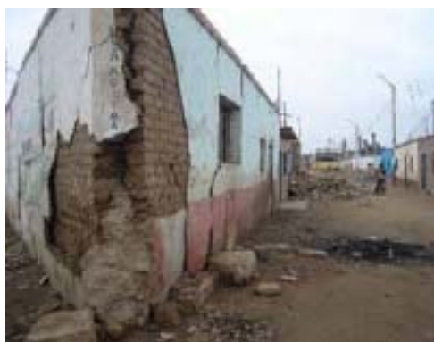
Figura 4.12 Estructura de 1 piso afectada por el sismo en Hualcarán 22
