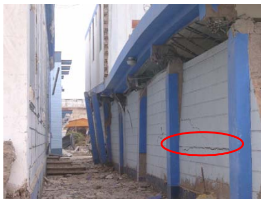
Figura 4.40 Falla por cizalle en el Hospital San Juan de Dios - Ica 38
