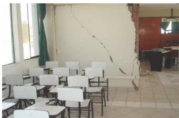
Figura 4.42 Falla por tracción diagonal - Pisco 40
