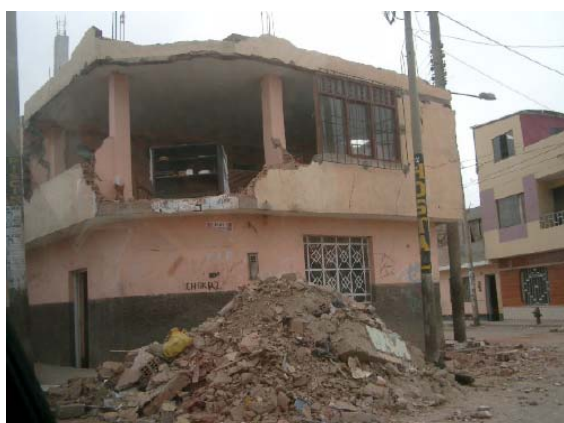
Figura 4.9 Daños sufridos en casa esquinera por efectos de torsión (Pisco) 19
