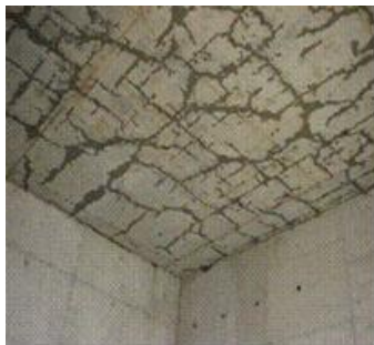
Figura N° 61: Fisuras por enfriamiento prematura y contracción por secado de una losa.
