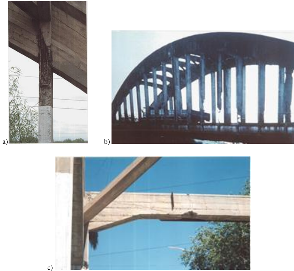
Figura N° 39: Impacto a) Moderado, b) Severo y c) Leve Fuente: Acciones sobre las estructuras de Hormigón. Manual de Rehabilitación de Estructuras de Hormigón. 2005 (6)
