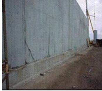
Figura N° 62: Fisuras por contracción impedida de origen térmico de un muro.
