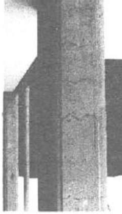
Figura N° 63: Fisuras por Asentamiento Plástico Fuente: Patología de la Construcción N° 45. ASEFA 2004. (2)
