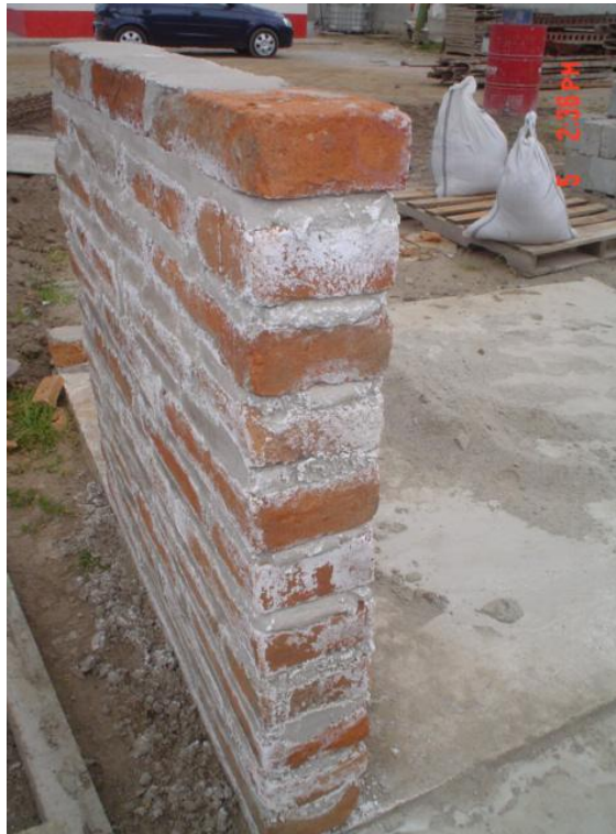
Foto N° 23: Ladrillo con eflorescencias
