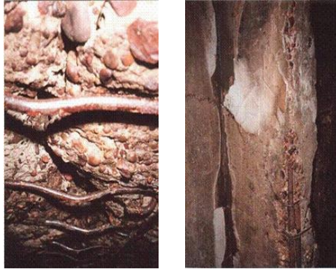
Figura N° 52: Rotura de una esquina de una losa, incendio localizado en el espacio interior
