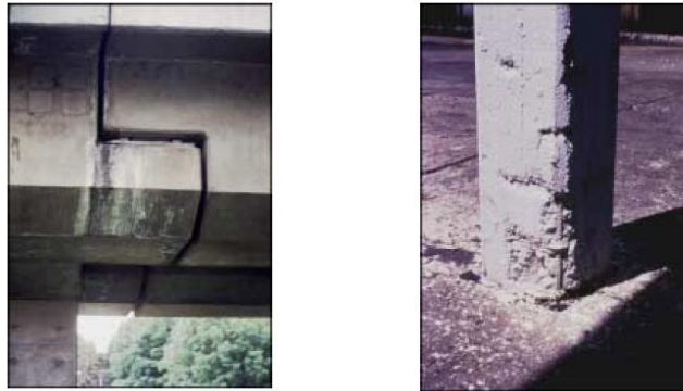
Figura N° 18: Las fotos muestran las estructuras afectadas por causa de la exposición a la intemperie, y porque no ha sido considerado el criterio de durabilidad dentro del diseño o construcción
