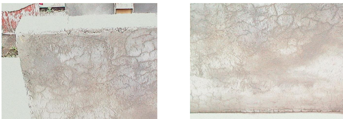
Foto N° 25: Mampostería enlucida con Arena de Lloa (Luce bien fisurada)
