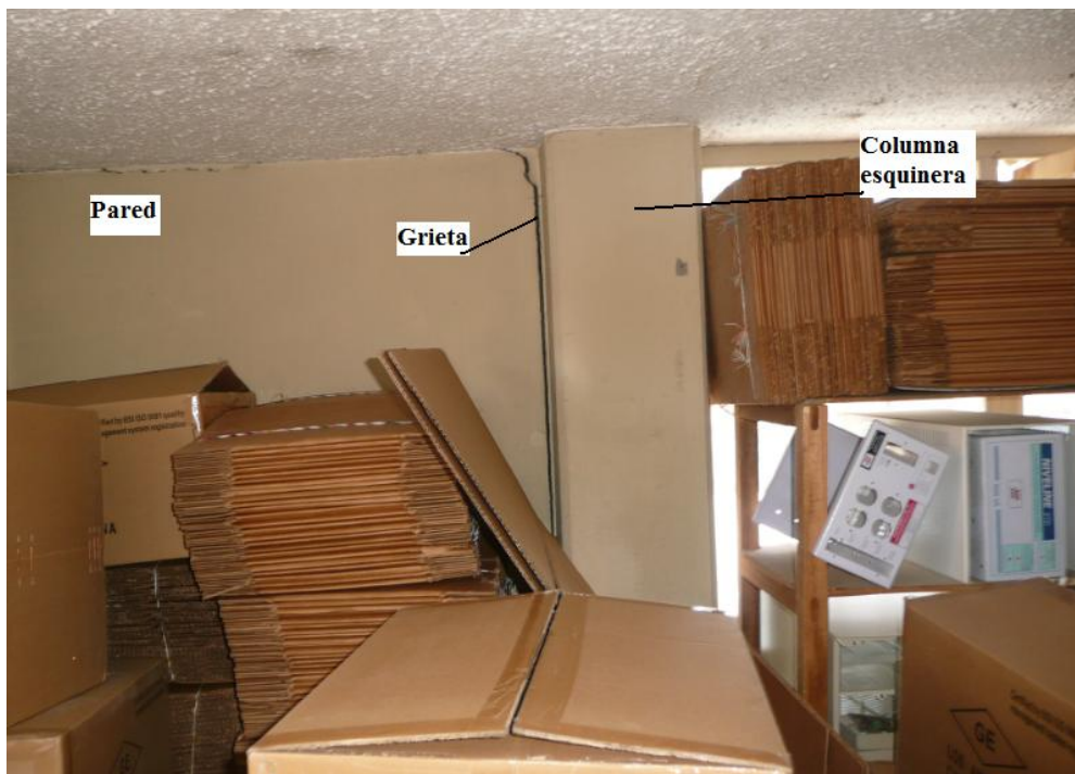
Columna esquinera y grieta visible.
