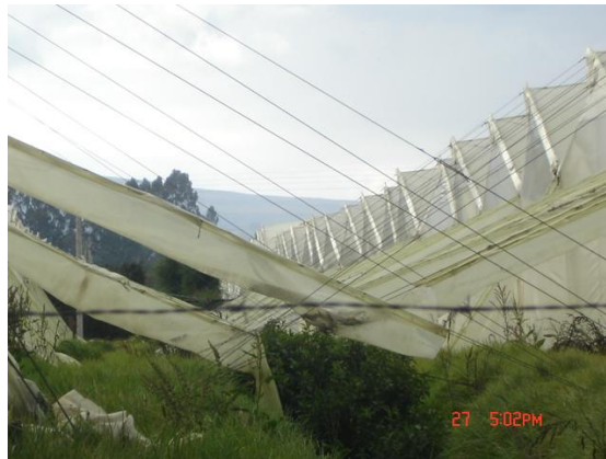
Fotografía 6.1 Cables que forman la estructura
