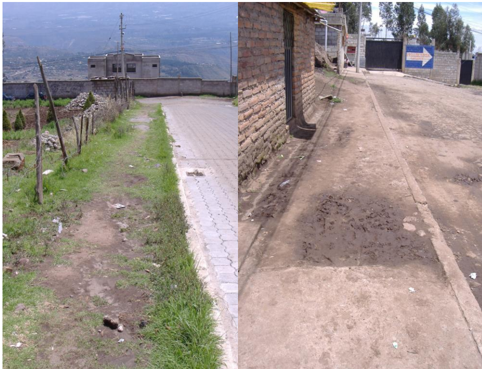
CONDICIONES DEL INICIO DE LA RUTA BUENOS AIRES – EL TREBOL EN MAL ESTADO
