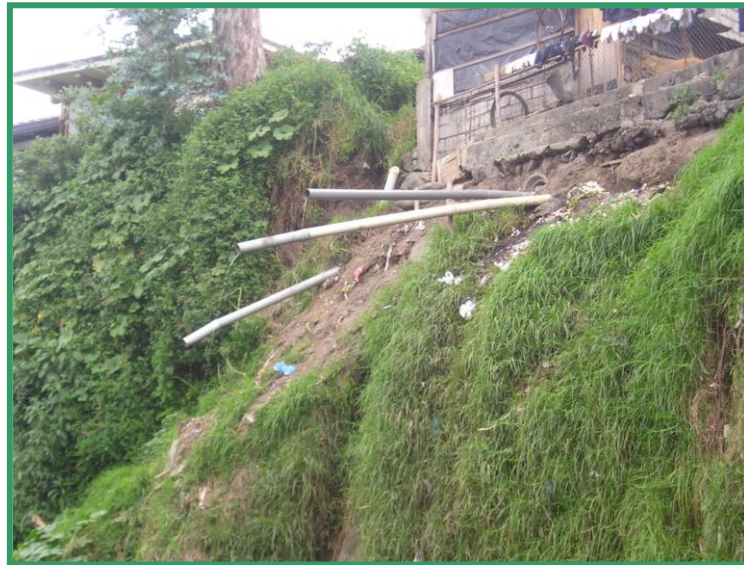
Fotografía 2.4.1 Obras con Inadecuado Drenaje
