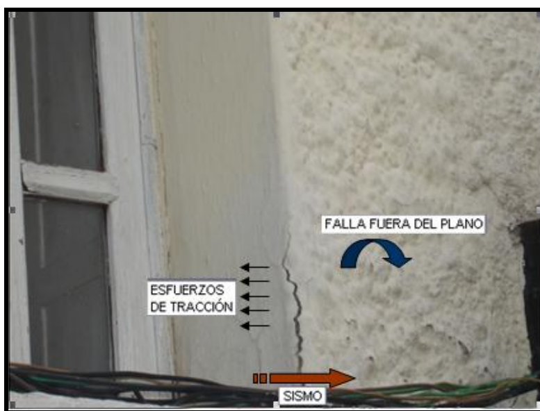
Figura 2.10. Fisuras en centro y uniones de paredes
