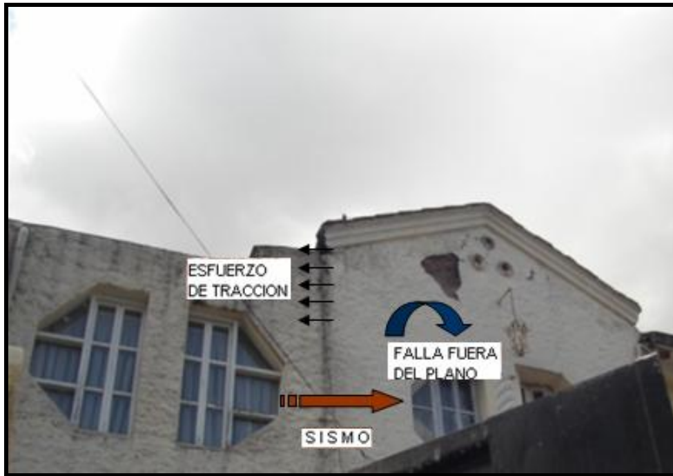
Figura 2.11. Fisuras en el tímpano
