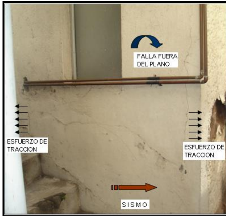
Figura 2.12. Fisuras a 45° en ambas direcciones
