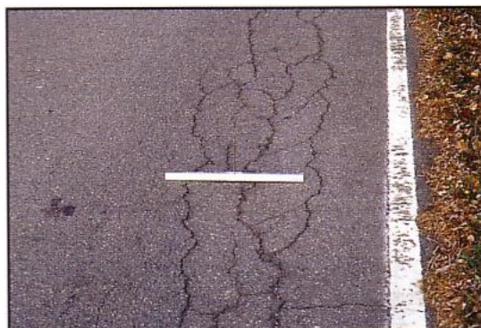
Fig 2. 4 Fisuración longitudinal debida a causas no estructurales (defecto en la colocación de la mezcla asfáltica.)
