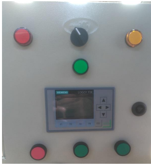
Figura 45. Tablero de Control
