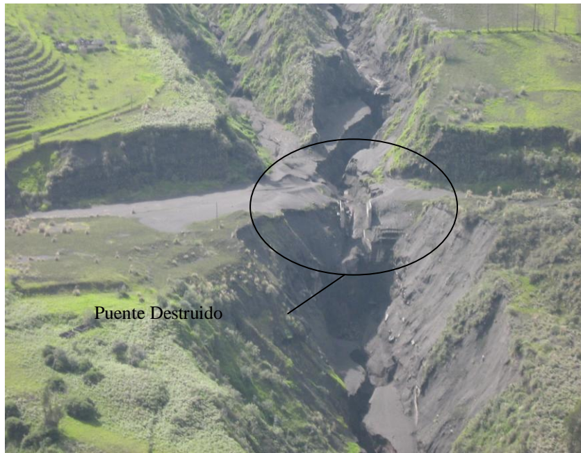
Foto No 3: destrucción de un puente localizado en el margen derecho del Volcán Tungurahua
