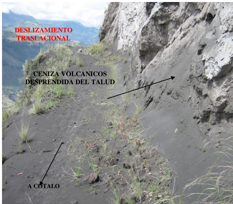
FOTO 11: ABSCISA: 4+100 Pequeño deslizamiento traslacional que afecta el talud de corte ocurrido en material tipo tobas, que ha interrumpido el camino existente.
