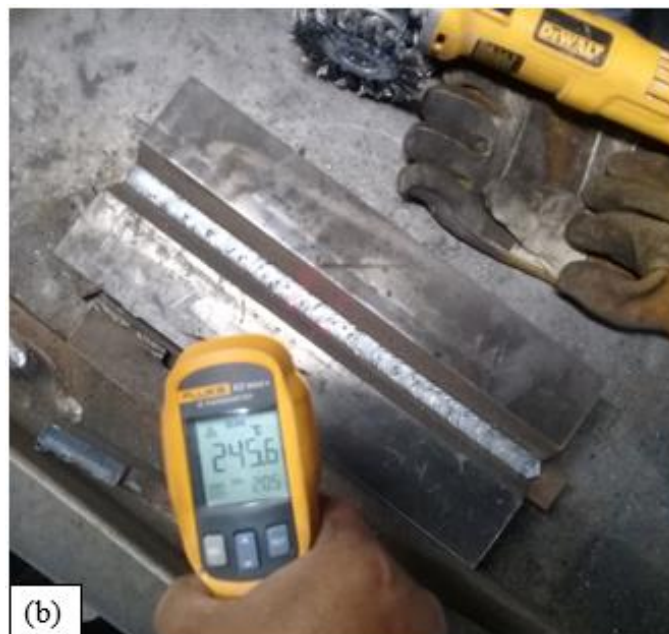
Figura 32. Controles durante la soldadura. (a) Control de intensidad de corriente, voltaje y velocidad de avance en el proceso GMAW. (b) Control de la temperatura entre pases y temperatura medida en el tercer pase de cordón de soldadura realizado en la junta de producción
