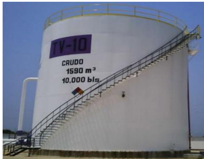
Figura 2. Tanque Vertical de Techo fijo
