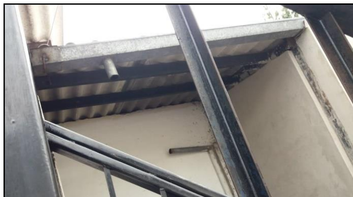
Figura 34 Sistema de desagüe del área de estudio
