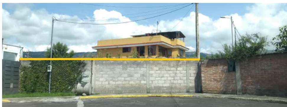
Figura 21. Debilidades de Seguridad en Barrera Perimetral, Calle Alberto Acosta Soberon.
