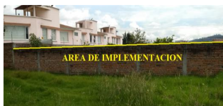
Figura 45. Implementación de Verjas de Seguridad en Muros Posteriores de la Urbanización "San José del Valle".
