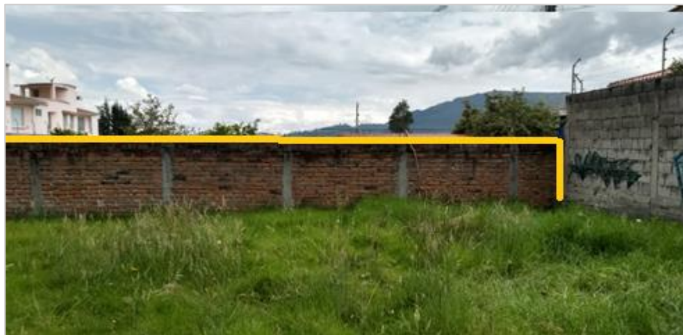
Figura 20. Debilidades de Seguridad en Barrera Perimetral- Zona Sur, junto a la Administración Zonal.
