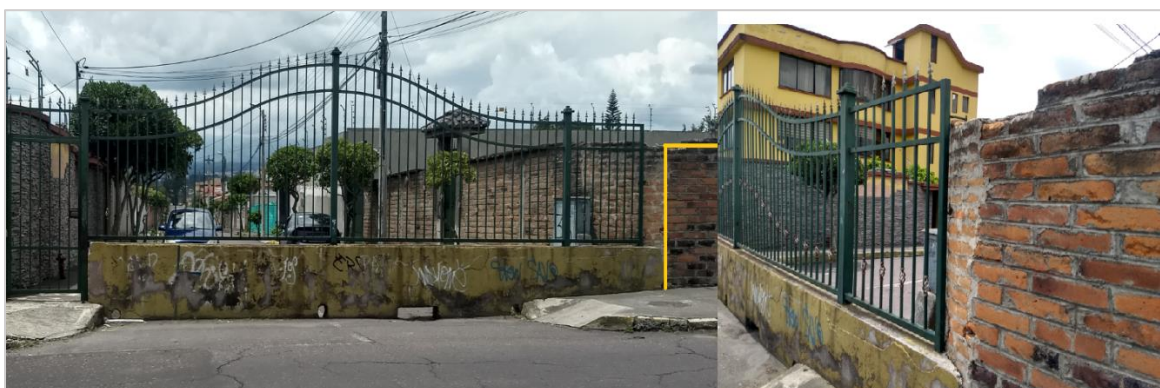
Figura 16. Debilidades de Seguridad del Acceso Ocho de la “Urbanización San José del Valle”.
