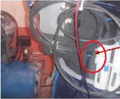
Alimentación de aire comprimido
