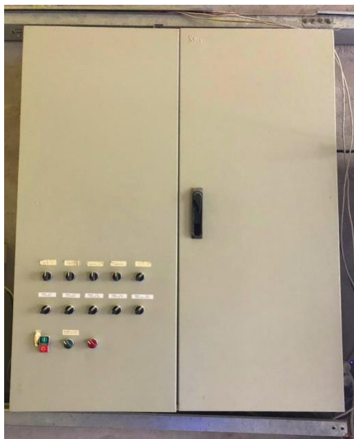
Figura 33. Tablero de Potencia
