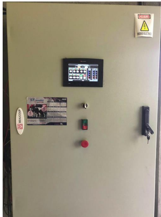
Figura 36. Tablero de Control
